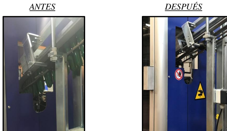
Figura 16. Antes y después deficiencia señalización riesgo atrapamiento
