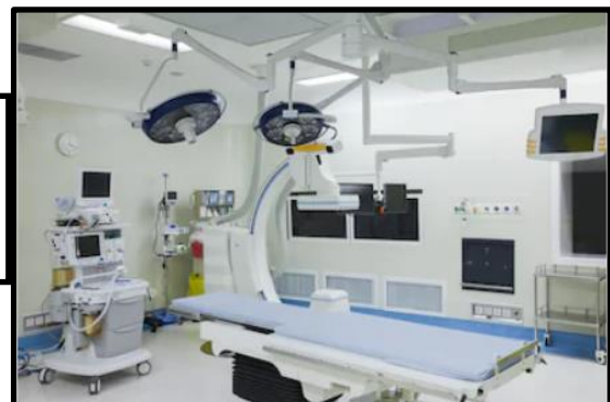
Figura 22. Quirófanos integrales con más de un monitor. Éstos caen desde el techo permitiendo la opción de situarse a la altura más ergonómica posible para el desarrollo de
