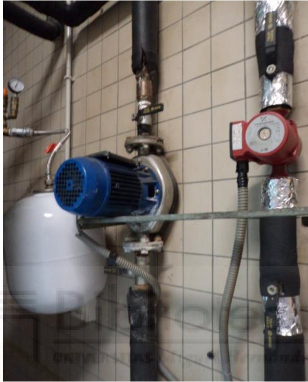
Figura 7: Bombas circuito secundario
