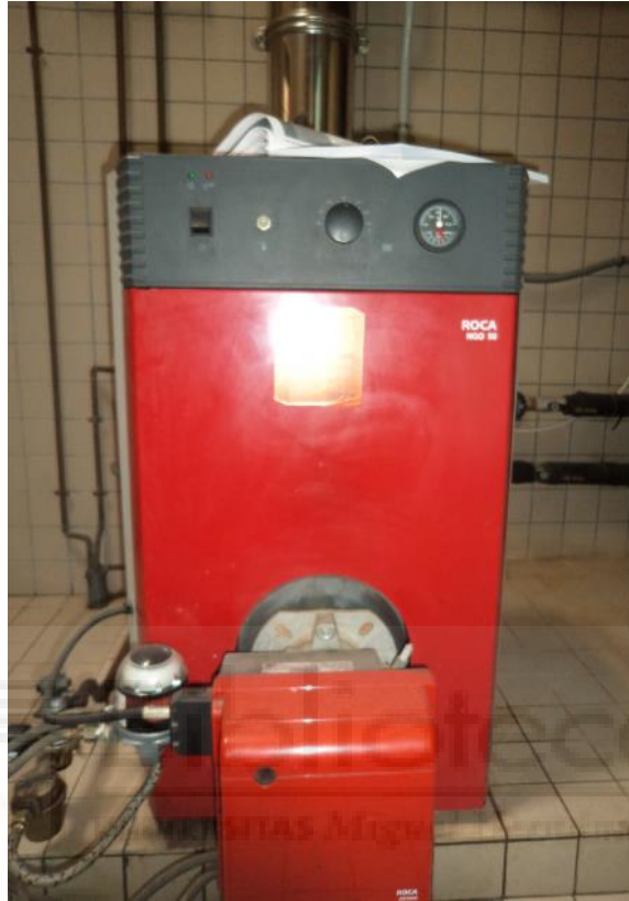
Figura 3: Caldera de gasóleo existente
