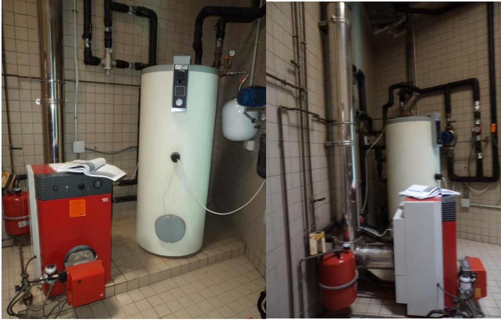
Figura 2: Cuarto de Calderas
