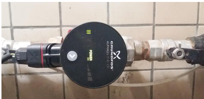
Figura 5: Bomba circuito primario
