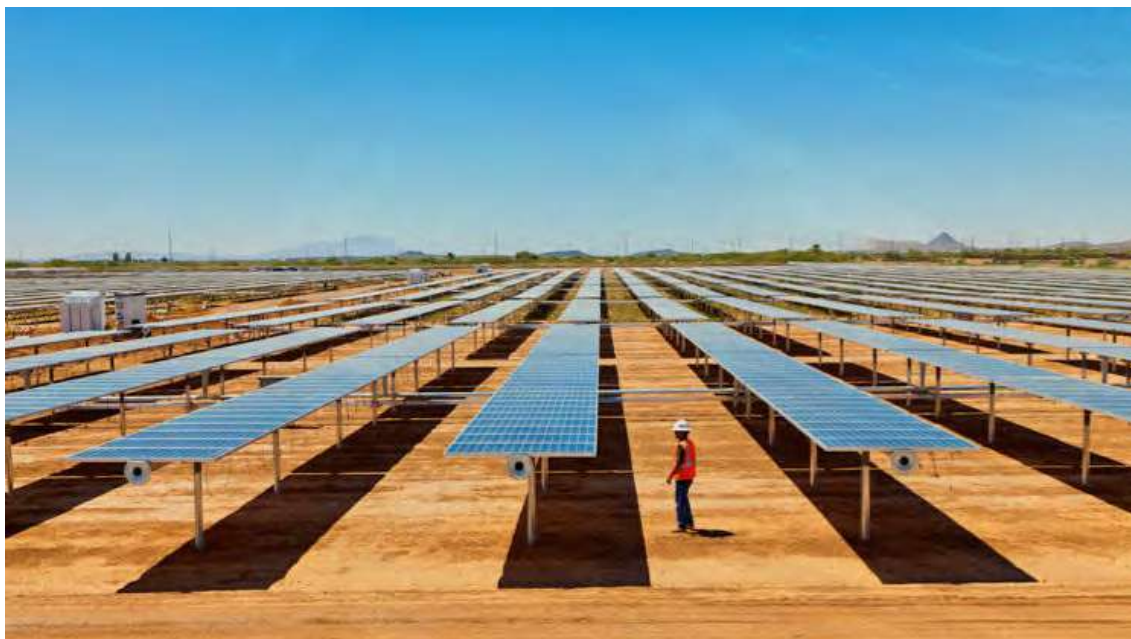
Figura 1.82: Planta solar fotovoltaica en Extremadura
