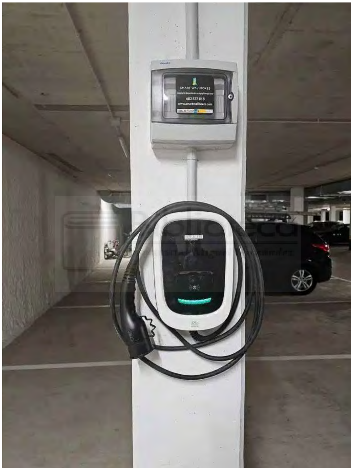
Figura 1.52: Punto de recarga en parking comunitario
