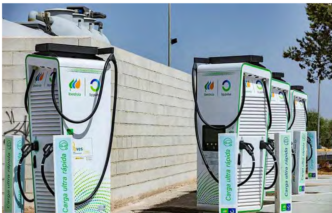
Figura 1.57: Estación de recarga pública de alta potencia en Sevilla con punto rápido de 50 kW y ultrarrápido de 400 kW
