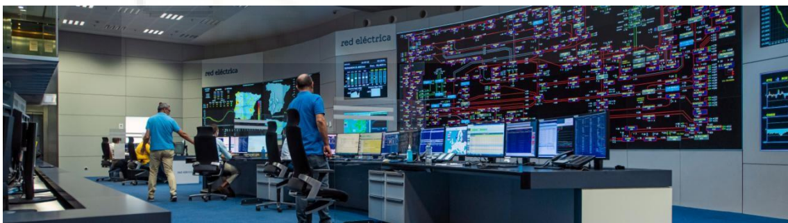
Figura 6. Centro de control de Red Eléctrica de España con operadores monitorizando el sistema en pantallas SCADA. Fuente: REE. Centros de control eléctrico.
