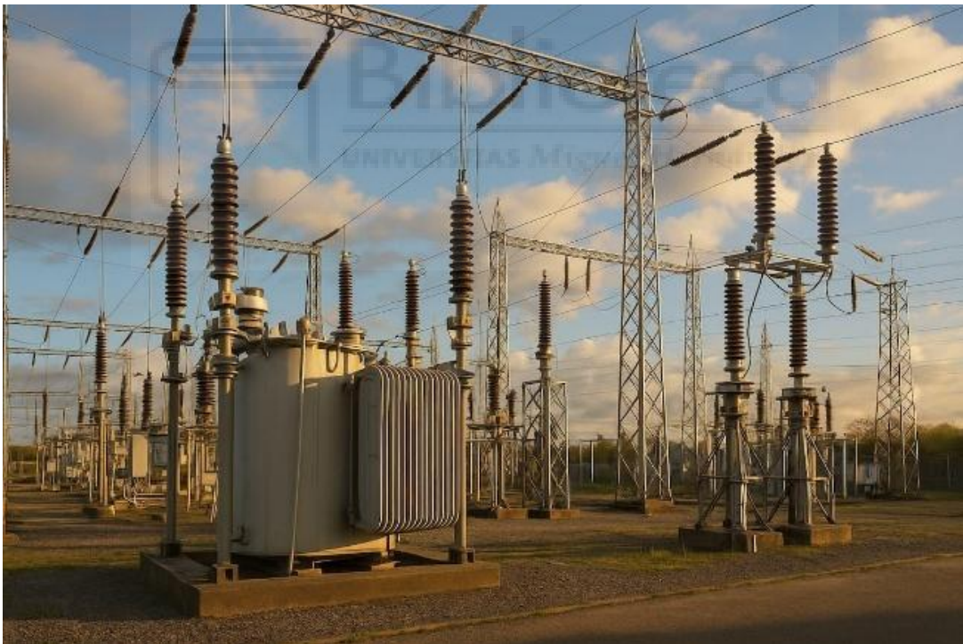
Figura 5. Fotografía de una subestación eléctrica de alta tensión con aisladores, transformadores e interruptores. Fuente: Energía y sociedad. Subestaciones eléctricas: Funcionamiento, tipos y componentes.
