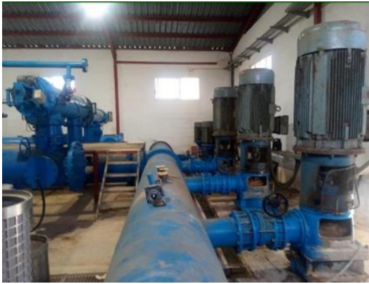
Estación de bombeo y filtrado N°1
