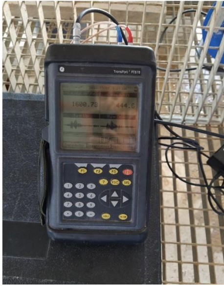
Detalle de medida del caudal en conducción de impulsión
