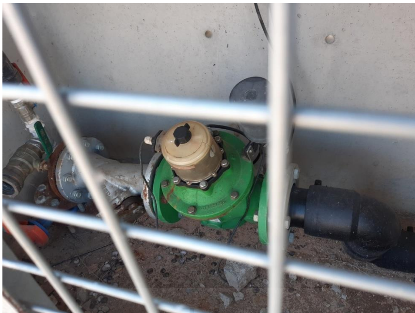
Contador situado en uno de los hidrantes
