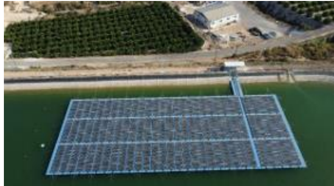
Instalación fotovoltaica flotante en el embalse N°3
