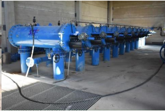
Estación de bombeo y filtrado N°2
