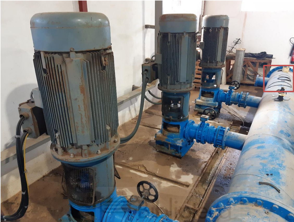
Vista de los tres grandes bombes de la estación de bombeo principal y hueco existente para la nueva bomba.
