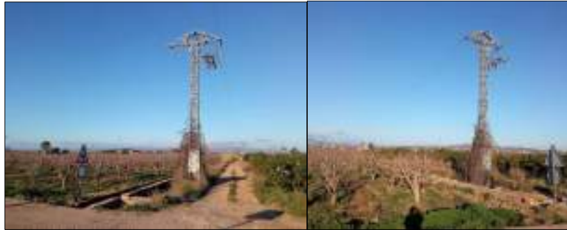
Imagen 14: Línea media tensión en camino adyacente a trazado sector 26
