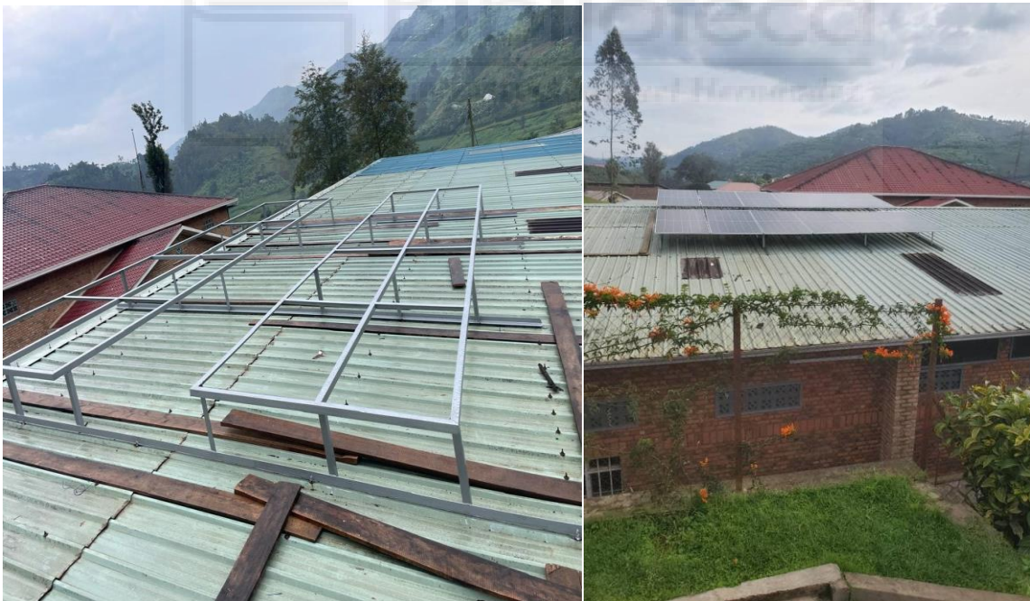
Ilustración 36. Proceso de montaje de módulos fotovoltaicos en la cubierta del edificio de lavandería.
