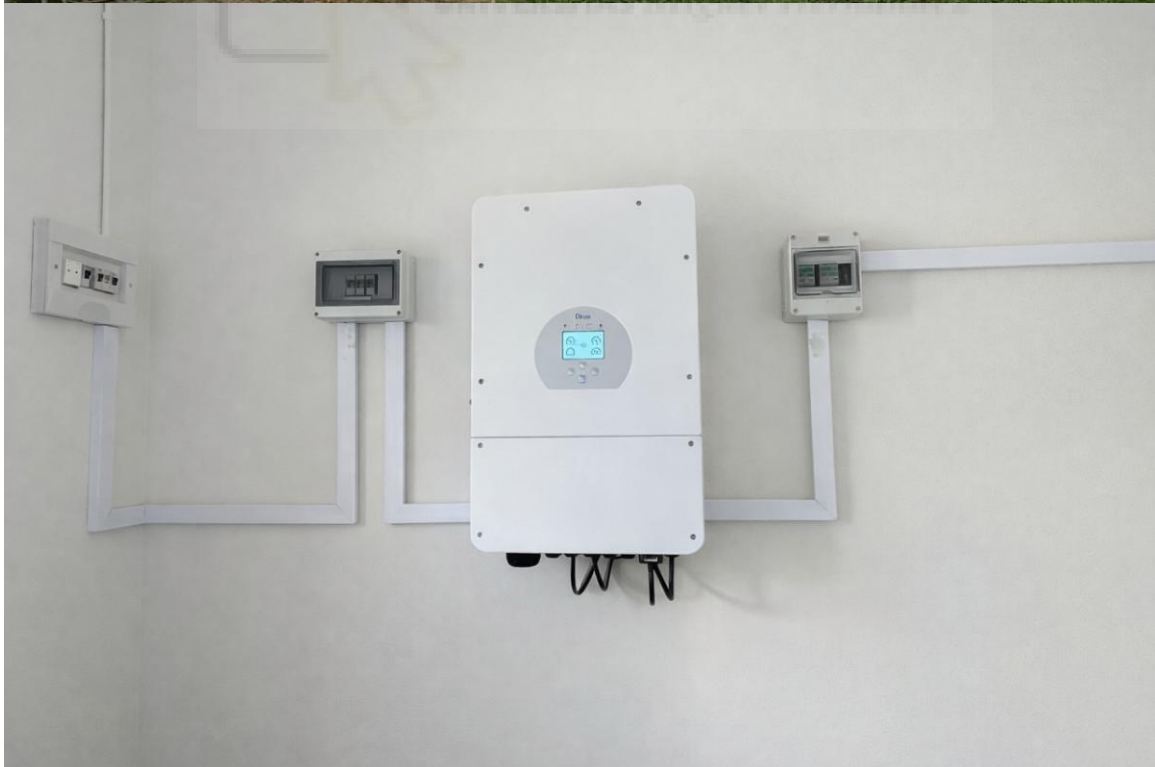
Ilustración 40. Sistema fotovoltaico instalado y en funcionamiento en el Hospital de Nemba.
