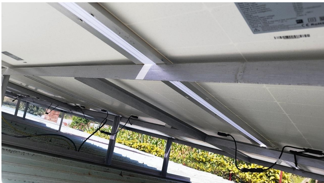
Ilustración 37. Conexión de paneles solares.
