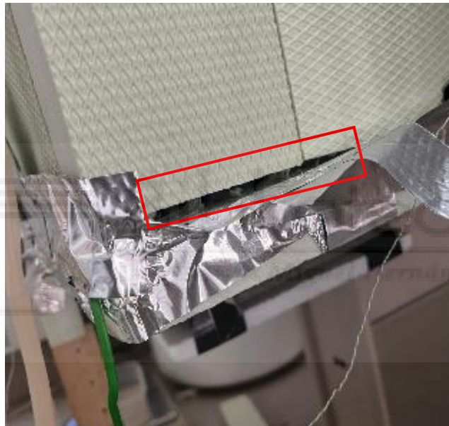
Figura 117. Base del equipo despegada
