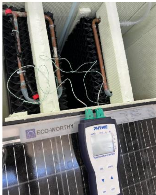
Figura 58. Dispositivo medidor de temperatura conectado al evaporador
