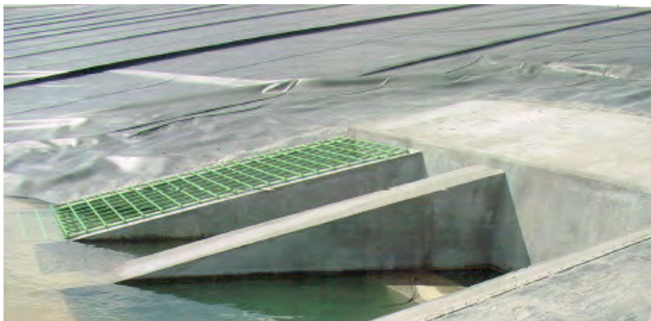
Fotografía 15. Entrada de agua mediante arqueta
