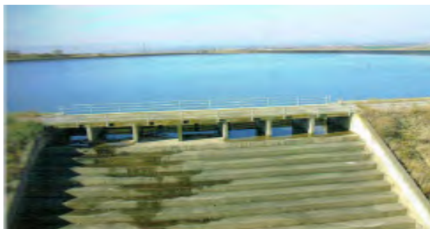
Fotografía 24. Aliviadero en canal escalonado
