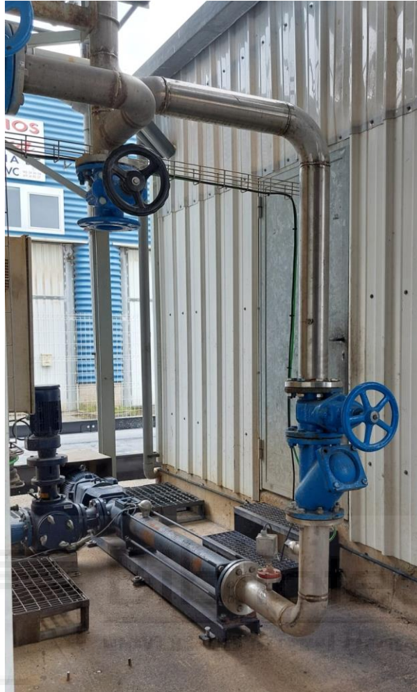
Imágenes 8. Bomba de fangos ubicada en la entrada a la cabina de descarga de residuos. Fuente: Elaboración propia.
