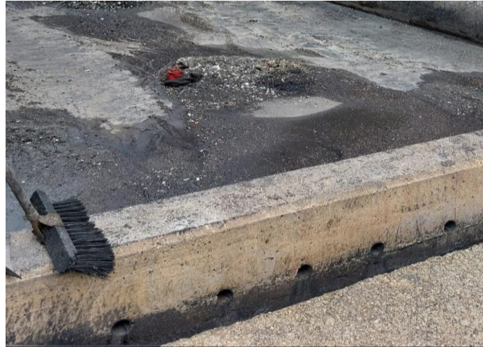
Imágenes 7. Desnivel no señalado en el carril de recogida de lixiviados de la limpieza de camiones. Fuente: Elaboración propia.
