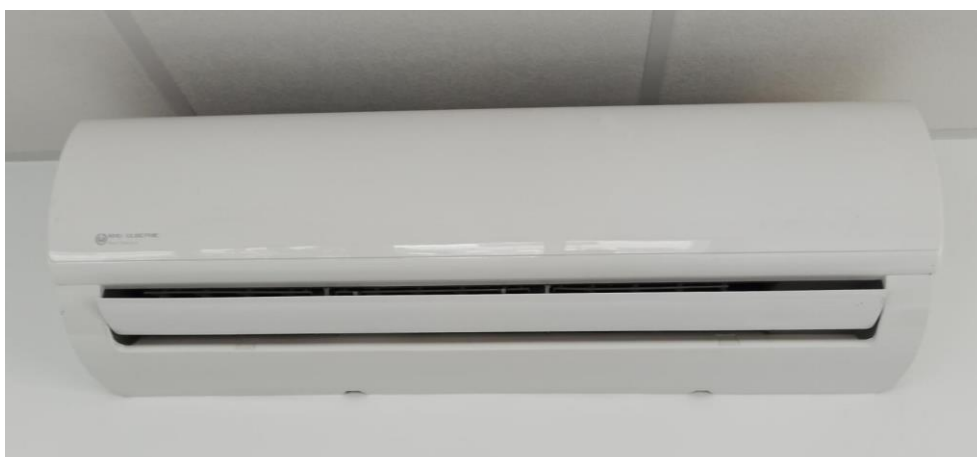
Fig. 33 Aire acondicionado Split
