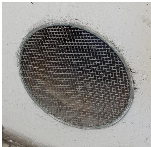
Fig. 35 Extractor para ventilación
