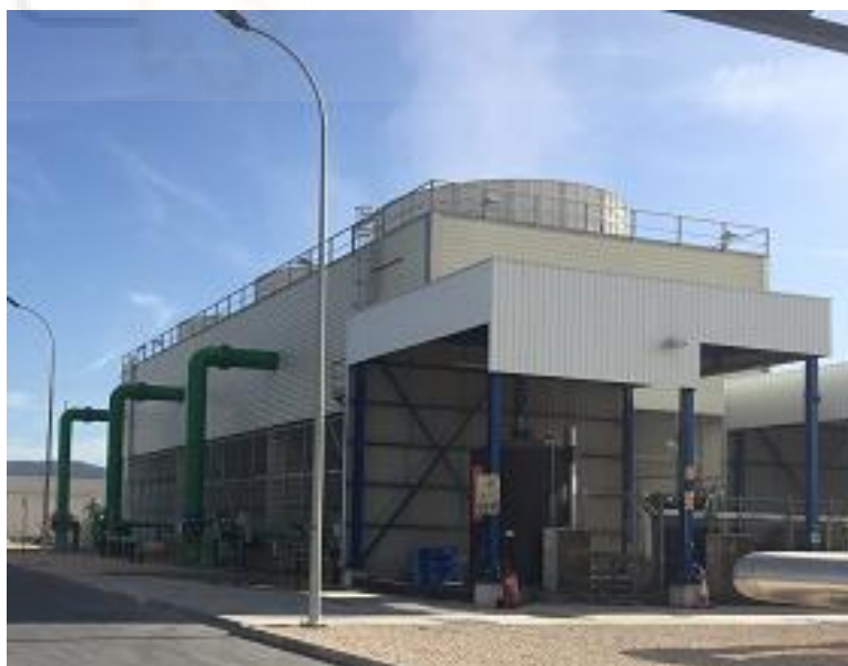
Figura 34. Imagen de la torre de refrigeración de la planta la Planta Enerstar-Villena. Marca ESINDUS
