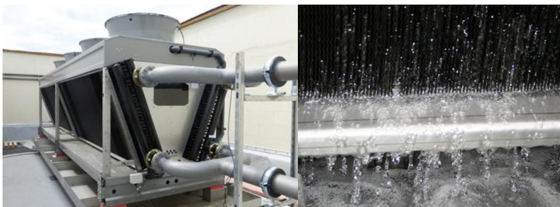
Figura 16. Refrigerador híbrido por deslizamiento (deluge). Fuente: Thermofin heat exchangers ©
