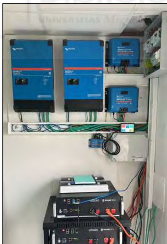
Ilustración 29 Ejemplo de vivienda en ejecución, sala de inversores, protecciones y baterías.
