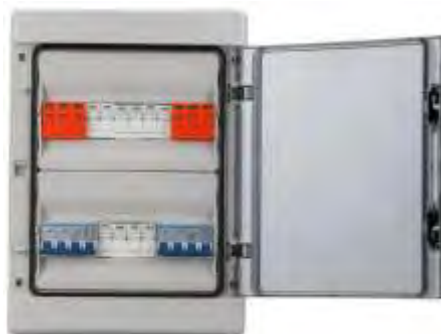
Ilustración 12 Ejemplo de Cuadro General de Mando y Protección en interior de vivienda.
