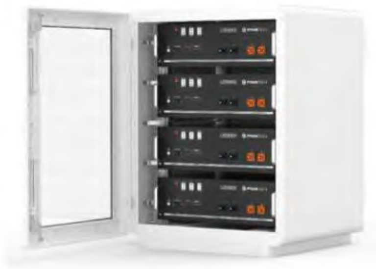
Ilustración 69 Baterías Pylontech US5000 apiladas.
