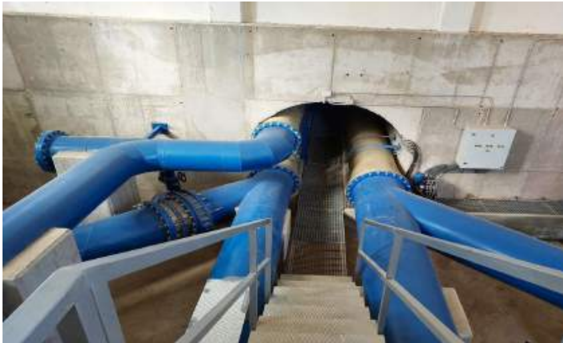
Vista de las tuberías de entrada/salida
