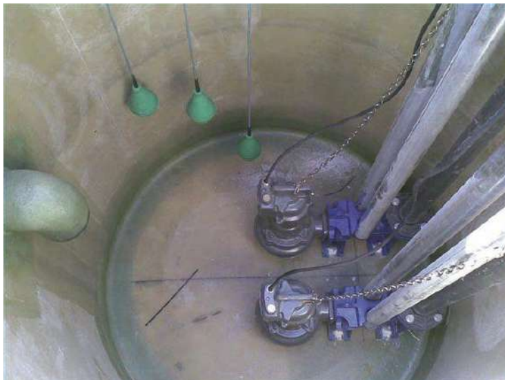
Figura 3. Pozo de bombeo con 2 bombas.
