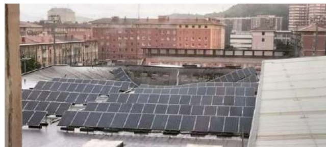
Figura 3: Cubierta hundida en Bilbao
