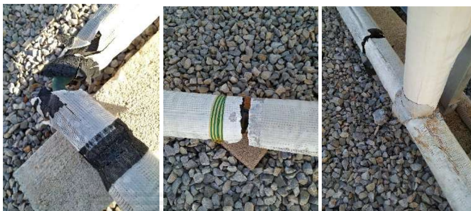
Imágenes 1, 2 y 3: Estado actual del circuito de los captadores solares
