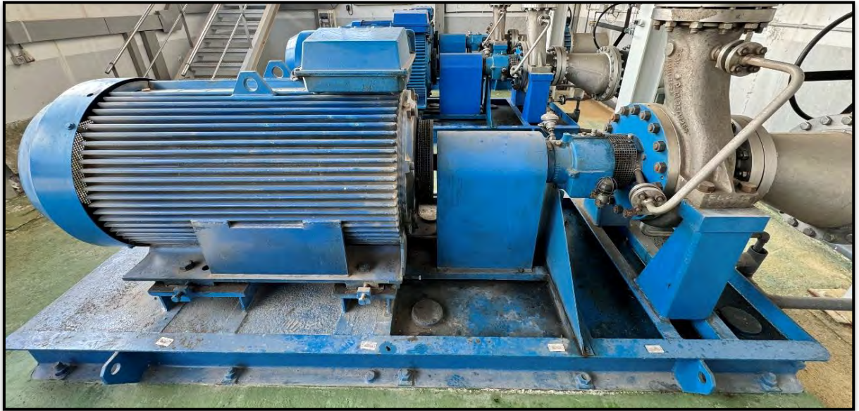
Ilustración 14-3: Foto del bombeo.
