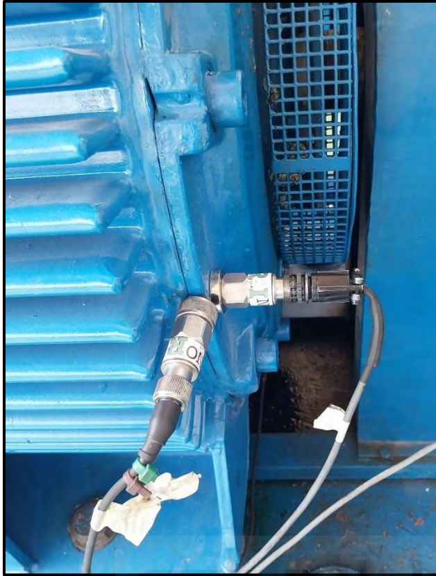
Ilustración 17-4: Foto de los sensores en el lado del motor acoplado.
