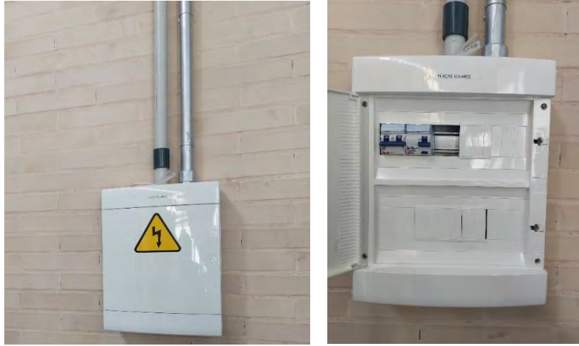
Figura 55. Cuadro eléctrico general
