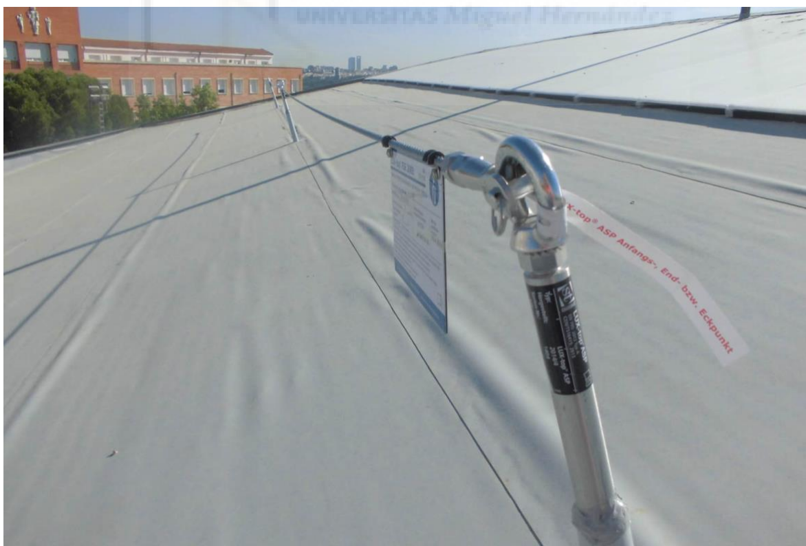
Figura 3: Soporte fijo en cubierta
