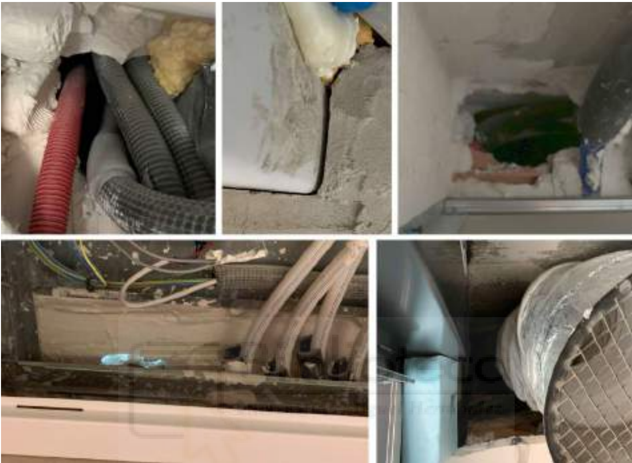
Figura 5.7: Práctica habitual. Diferentes ejemplos de orificios y agujeros dejados en los puntos de paso de instalaciones.
