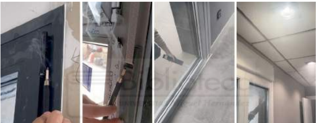
Figura 5.4: Localización de defectos de hermeticidad en ventanas mediante generador de humo.
