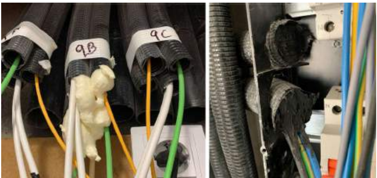
Figura 7.3: Izquierda conducto de cableado al aplicar la «M1 - Mejora básica». Derecha conducto de cableado al aplicar «M2 - Mejora avanzada».
