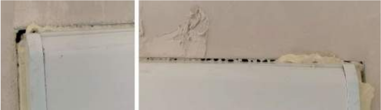
Figura 7.2: Pequeños huecos en el perímetro de una ventana al aplicar «M1 - Mejora básica».
