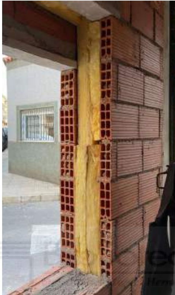
Figura 2.3: Detalle del sistema típico constructivo de fachadas en España y el sur de Europa. Fachada de doble hoja cerámica con aislamiento térmico intermedio.
