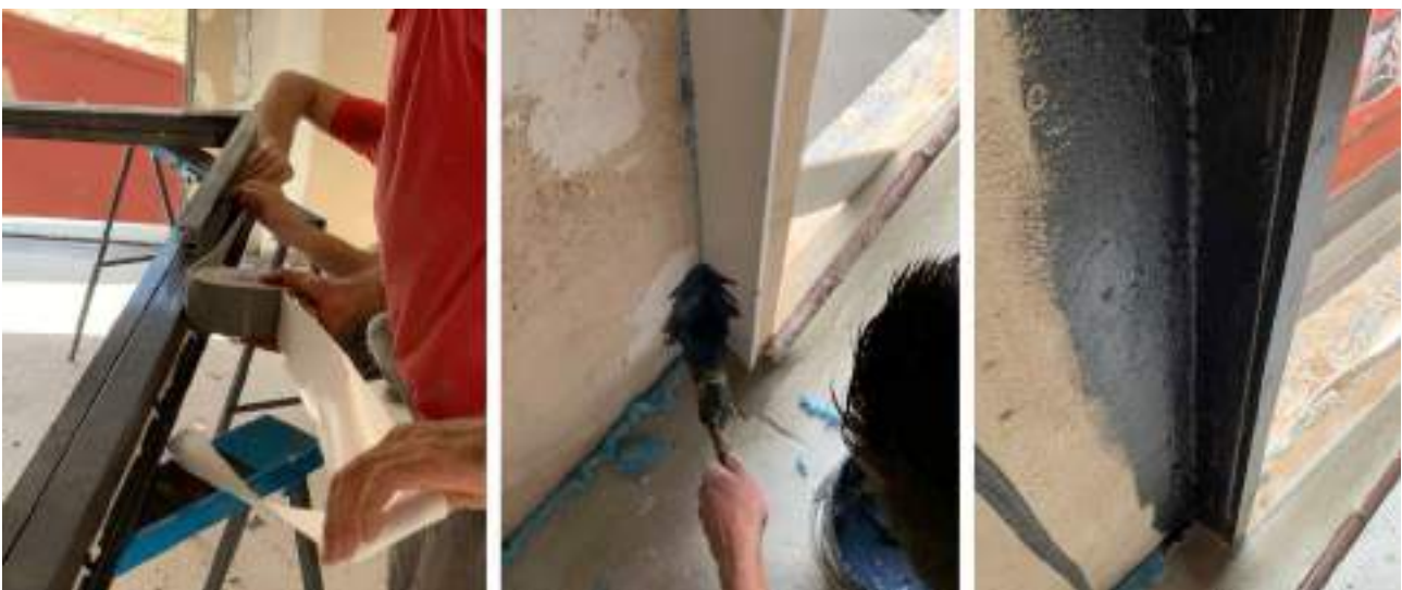
Figura 5.10: M2 Mejora avanzada. Colocación de cinta precomprimida y membrana líquida de hermeticidad aplicada en el marco.
