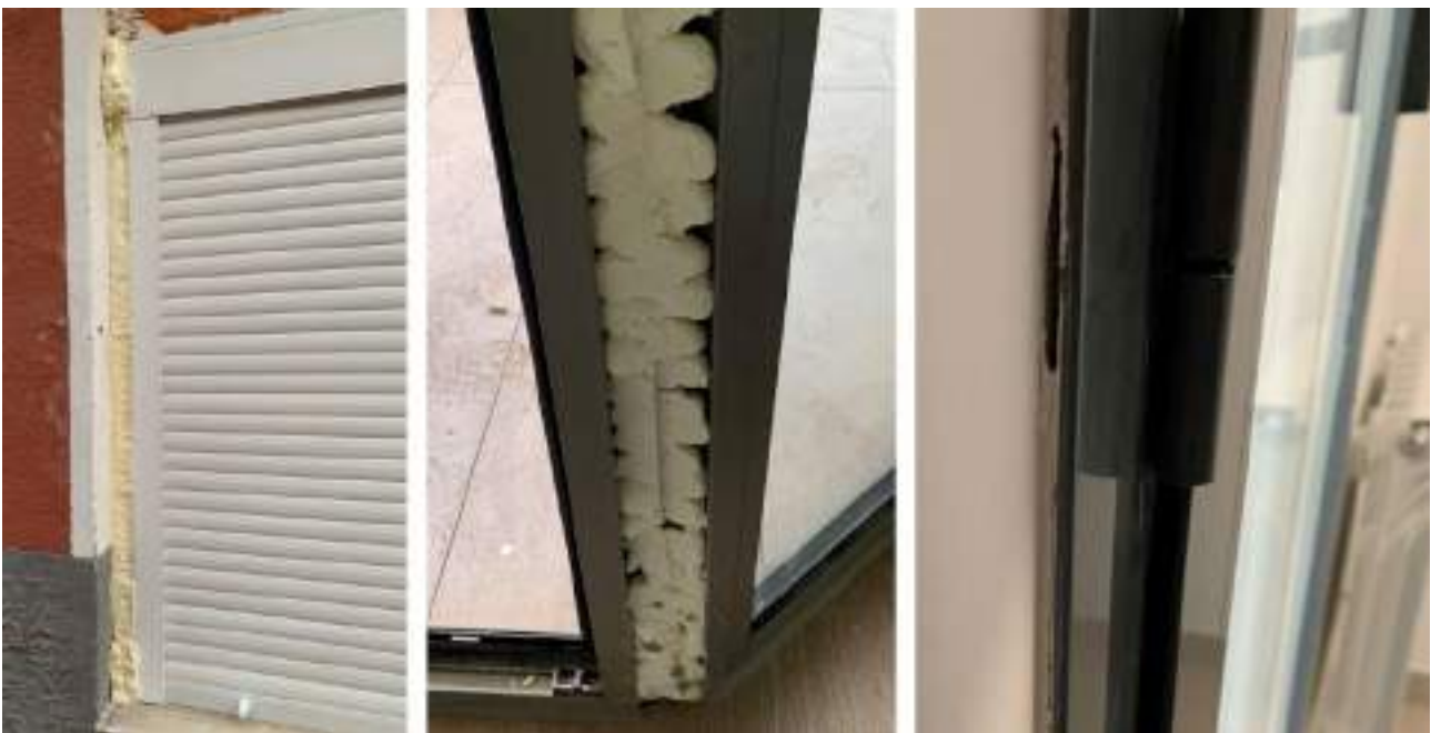
Figura 5.6: Práctica habitual. Relleno del perímetro de ventanas con espuma de poliuretano generando pequeños orificios que generan infiltraciones de aire.
