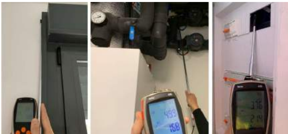
Figura 5.3: Localización de defectos de hermeticidad mediante anemómetro utilizado para localizar entradas o salidas de aire en las cajas de persiana e instalaciones.
