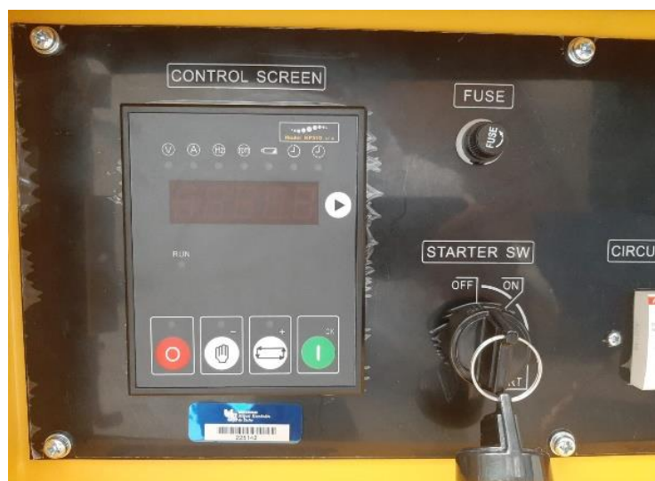
Ilustración 13: Detalle panel de control de la unidad
