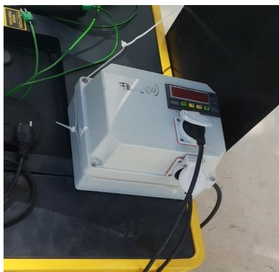
Ilustración 135: Equipos de medida, vatímetro industrial
