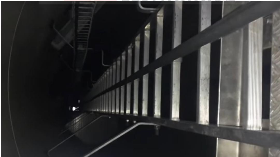
FOTO NÚM. 5: TRAMO ESCALERA INTERIOR DE UN AEROGENERADOR
