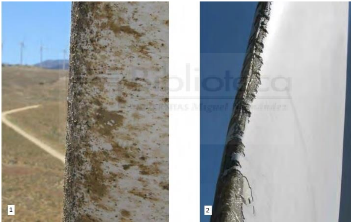
FOTO NÚM. 35: SUCIEDAD (1) Y DESCONCHADO (2) DEL BORDE DE ATAQUE DE UNA ASPA
