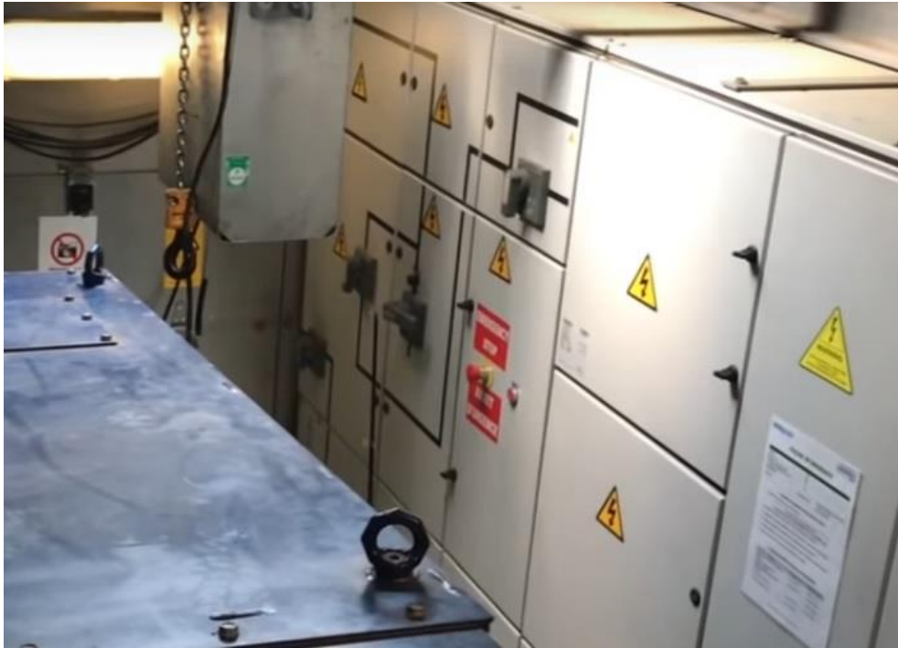
FOTO NÚM. 8: SETA PARTE TRASERA DE LA NACELLE EN LOS ARMARIOS ELÉCTRICOS
