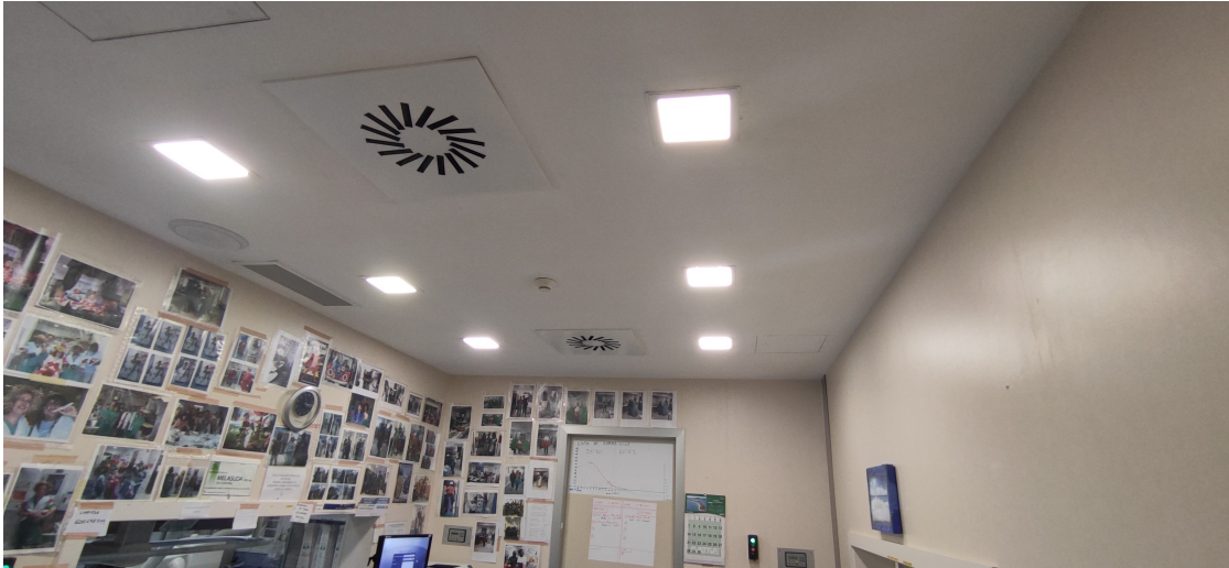
Figura 4: Detalle de la luminaria de la sala
