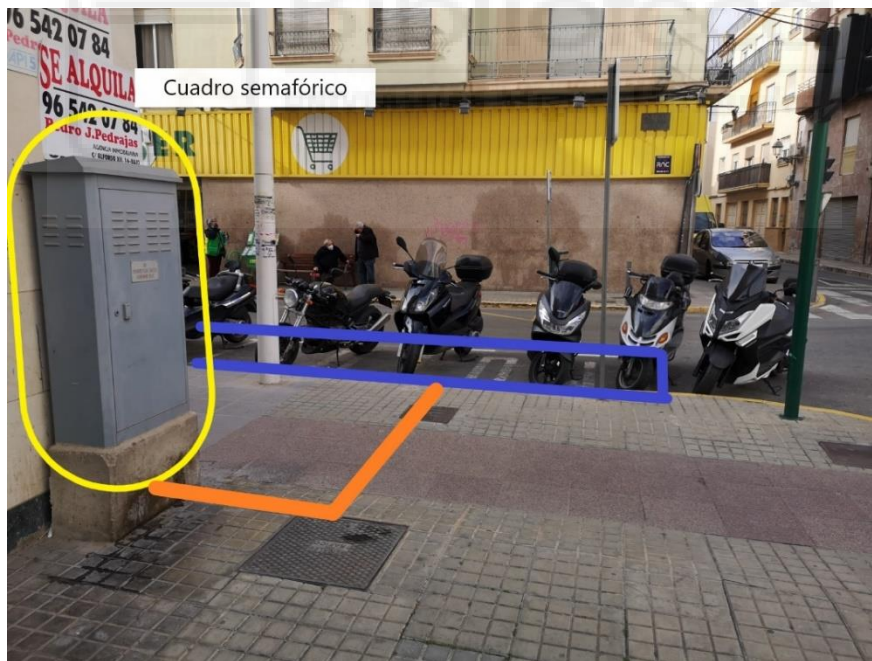
FIGURA 150: Acometida eléctrica de la estación C.S. Raval.
