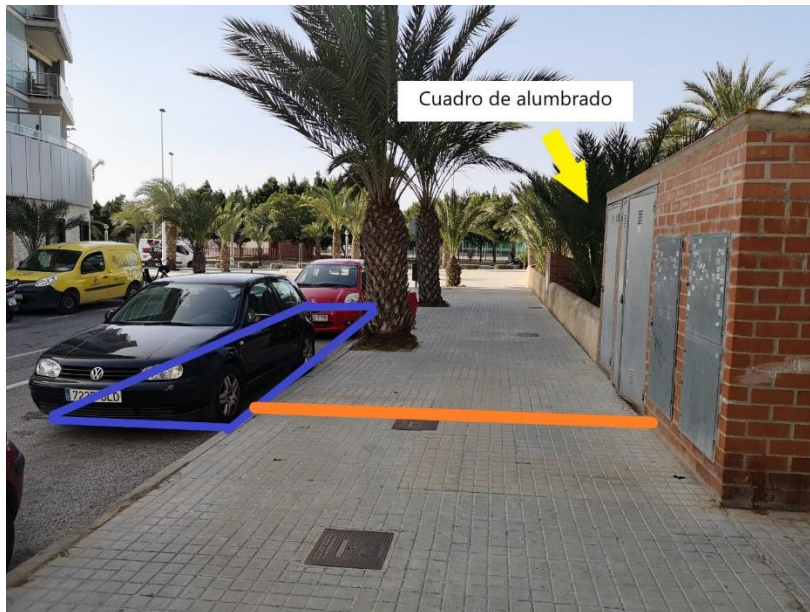
FIGURA 173: Acometida eléctrica de la estación Parque Huerto del Torreret.
