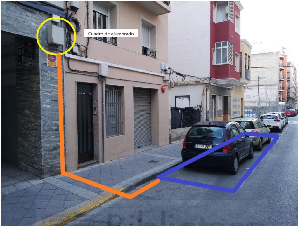
FIGURA 90: Acometida eléctrica de la estación Miguel Hernández – Espronceda.
