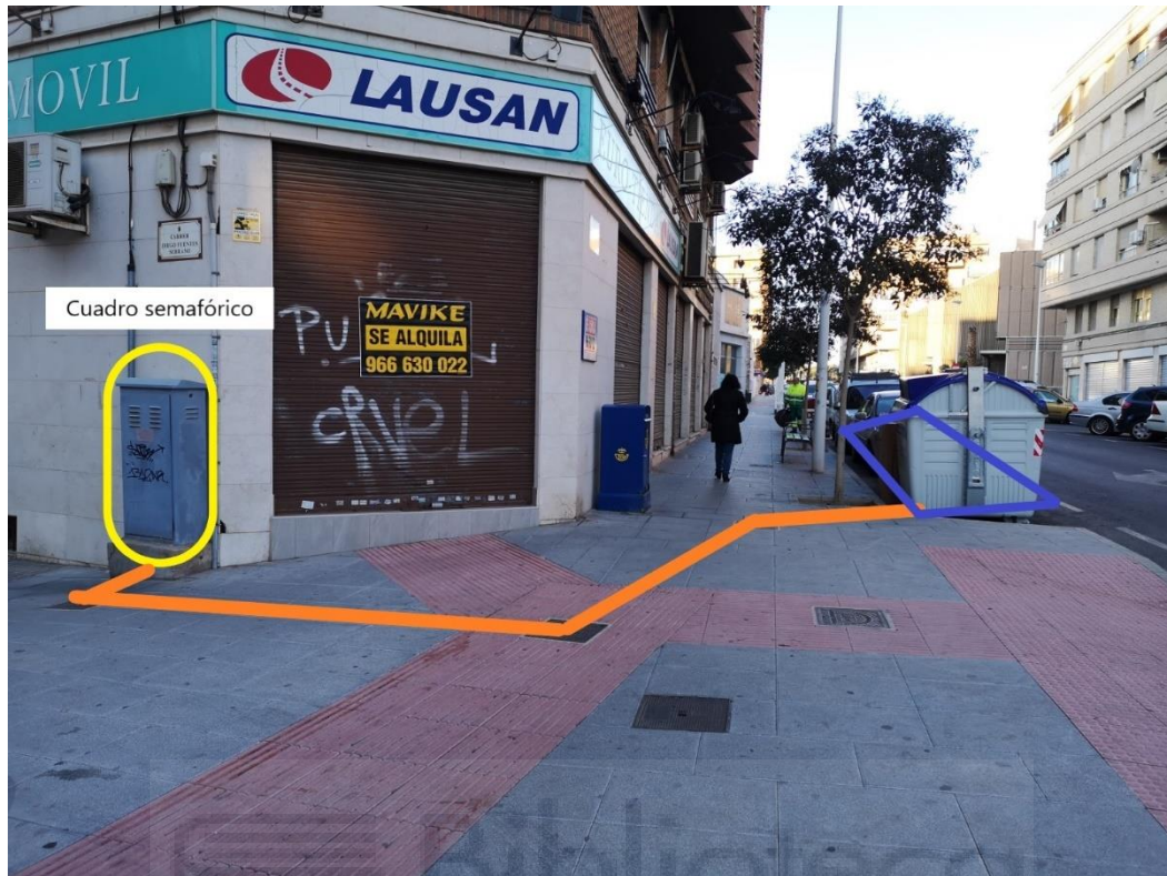
FIGURA 96: Acometida eléctrica de la estación Antonio Machado, 73.
