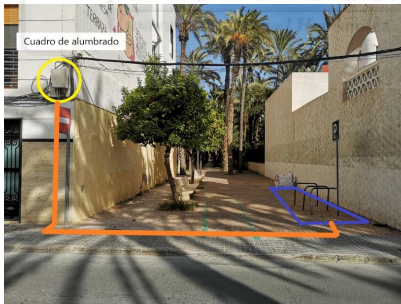
FIGURA 140: Acometida eléctrica de la estación Salesianos.
