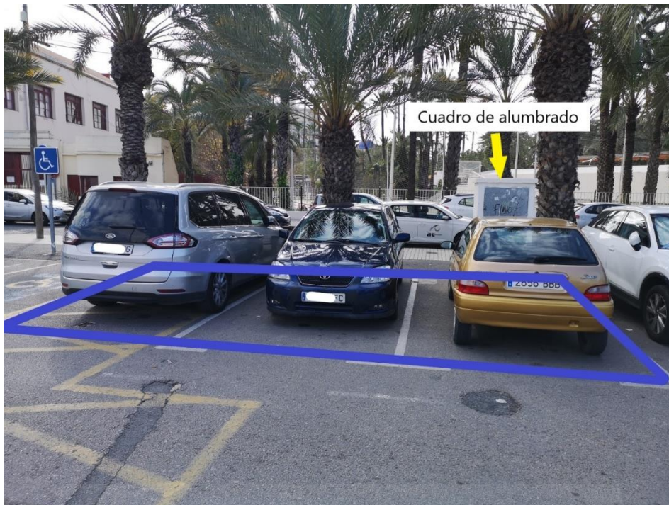
FIGURA 126: Acometida eléctrica de la estación Parking Candalix.
