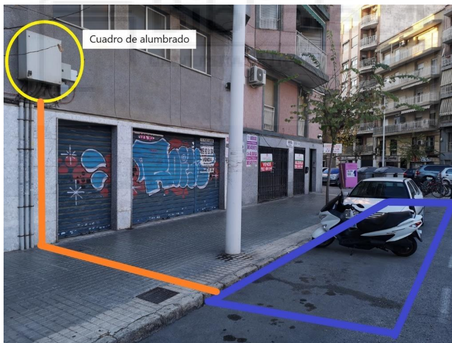
FIGURA 80: Acometida eléctrica de la estación Plaza Obispo Siuri.
