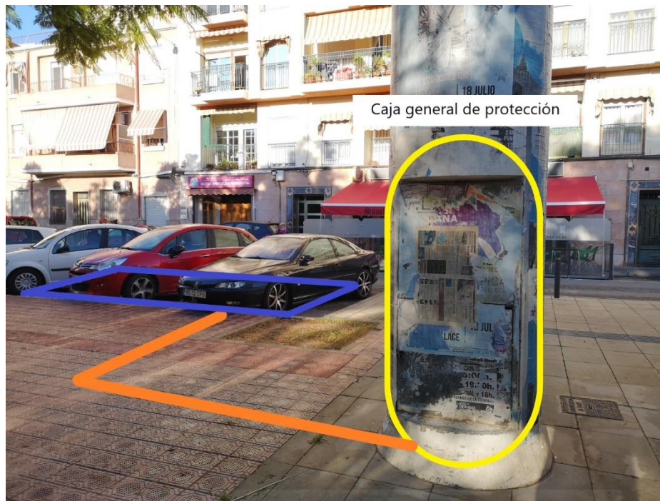
FIGURA 69: Acometida eléctrica de la estación Plaça de l'Aparadora.
