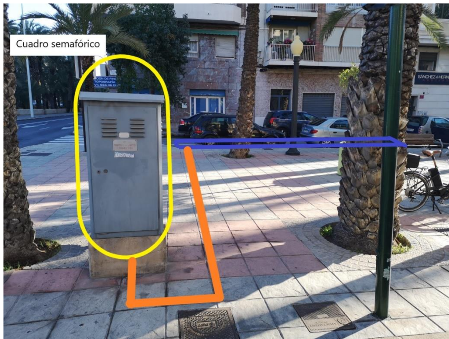
FIGURA 129: Acometida eléctrica de la estación Parque Rey Jaime I.
