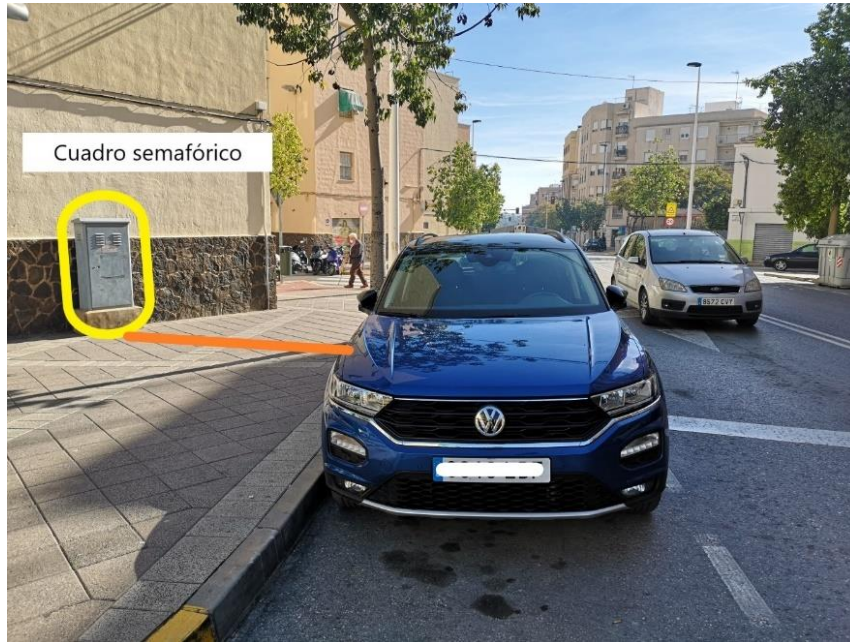
FIGURA 51: Acometida eléctrica de la estación Prof. Francisco Tomás – Victoria Kent.
