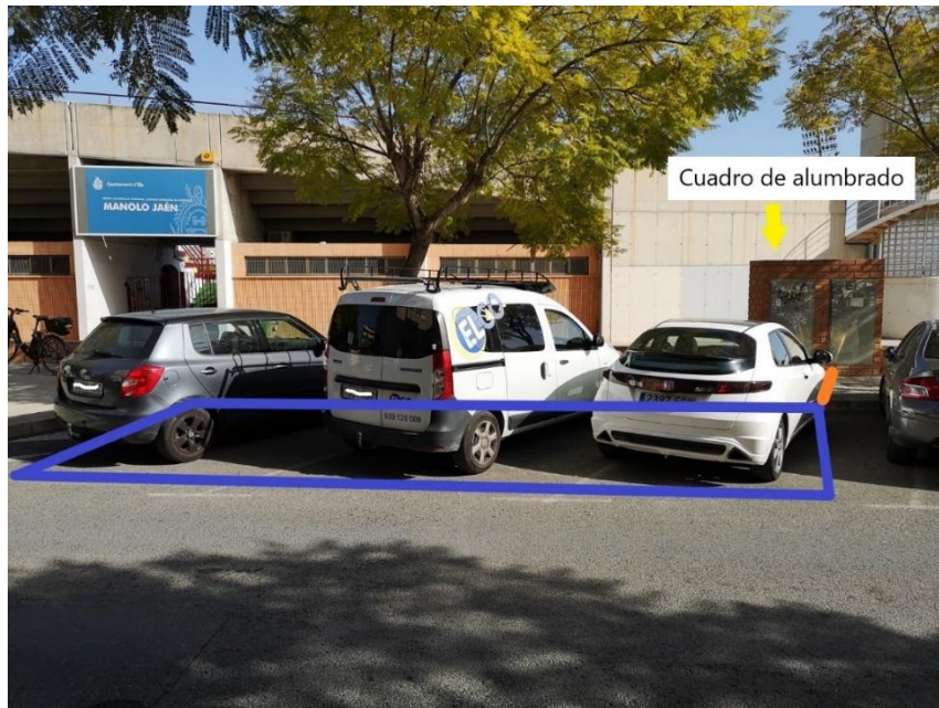
FIGURA 164: Acometida eléctrica de la estación Polideportivo Altavix 2.
