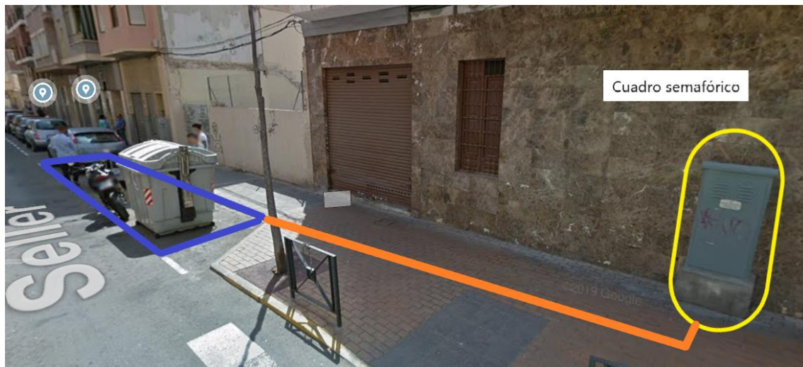
FIGURA 57: Acometida eléctrica de la estación Camí dels Magros.
