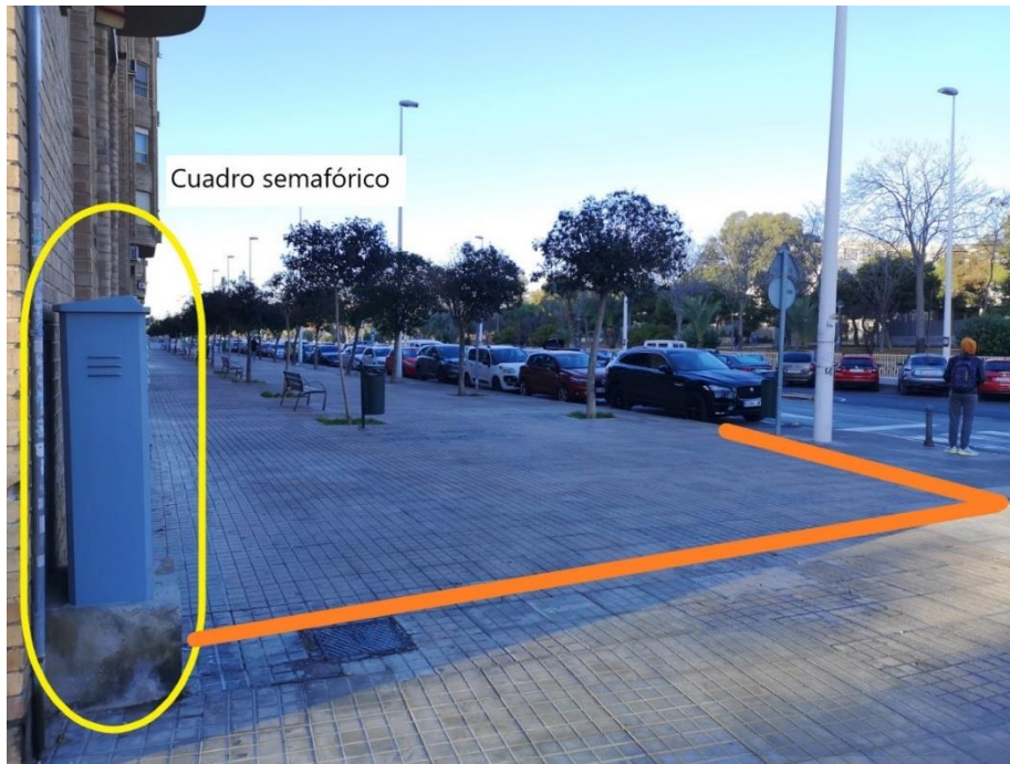
FIGURA 39: Acometida eléctrica de la estación CEIP Eugeni d'Ors.
