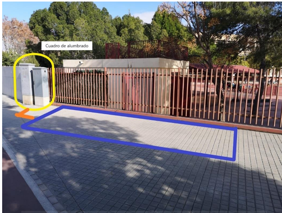
FIGURA 117: Acometida eléctrica de la estación IES Periodista Vicente Verdú.
