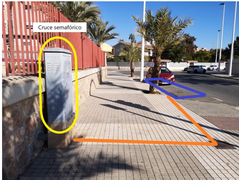
FIGURA 182: Acometida eléctrica de la estación CEIP San Fernando.
