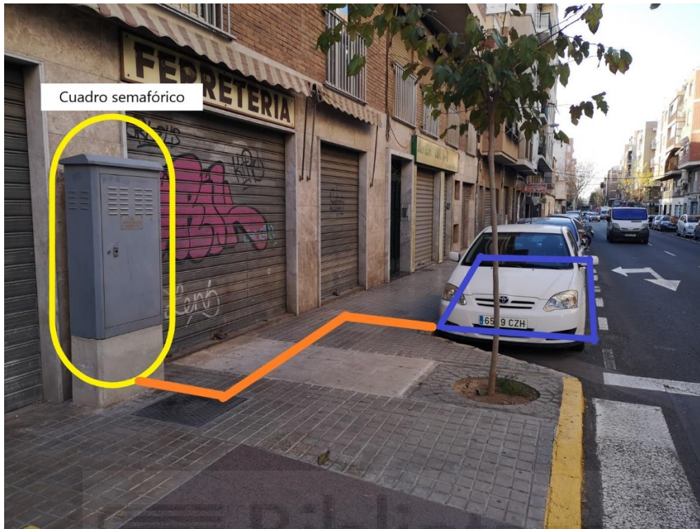
FIGURA 99: Acometida eléctrica de la estación Conrado Campo.
