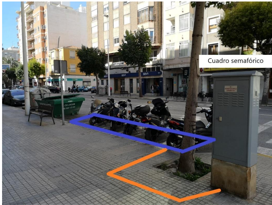
FIGURA 179: Acometida eléctrica de la estación Avenida Alicante, 23.
