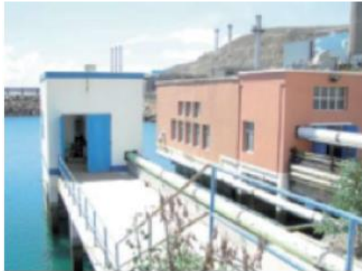
Figura25. Captación abierta de agua de mar. Desaladora Las Palmas III. Fuente: www.quimicadelagua.com
