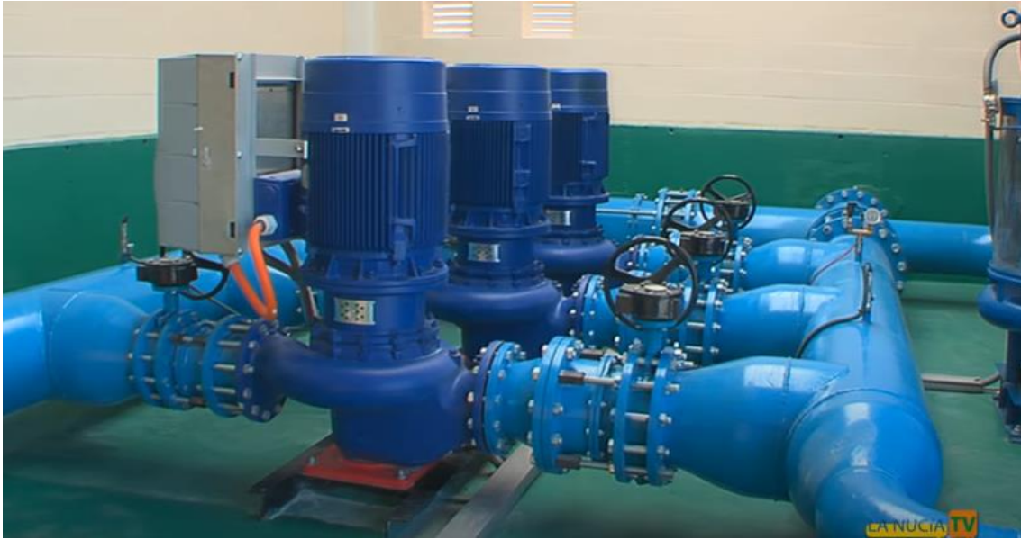
Figura35. Estación de bombeo de agua potable de La Nucía. Fuente: “La Nucía TV”
