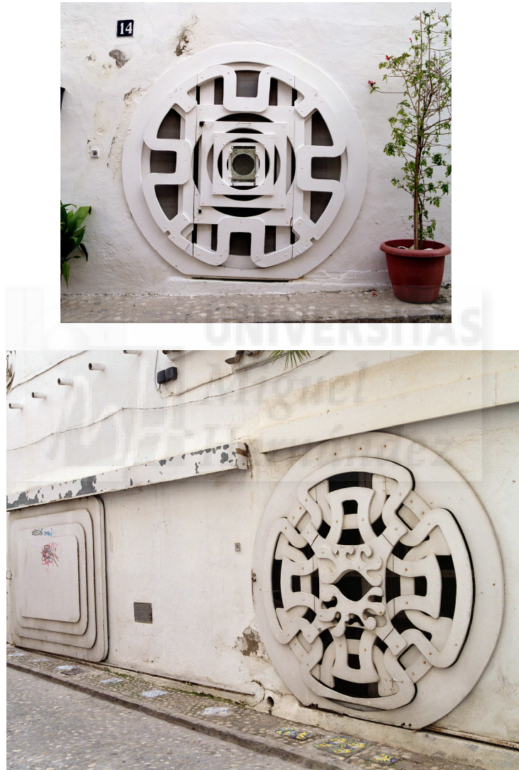
Foto 4. Detalle de las Puertas de la casa del Pintor Alcoyano Antoni Miró, también conservadas en muy mal estado, entrada de la C/ Consuelo y entrada de la C/ Fondo en Altea.
