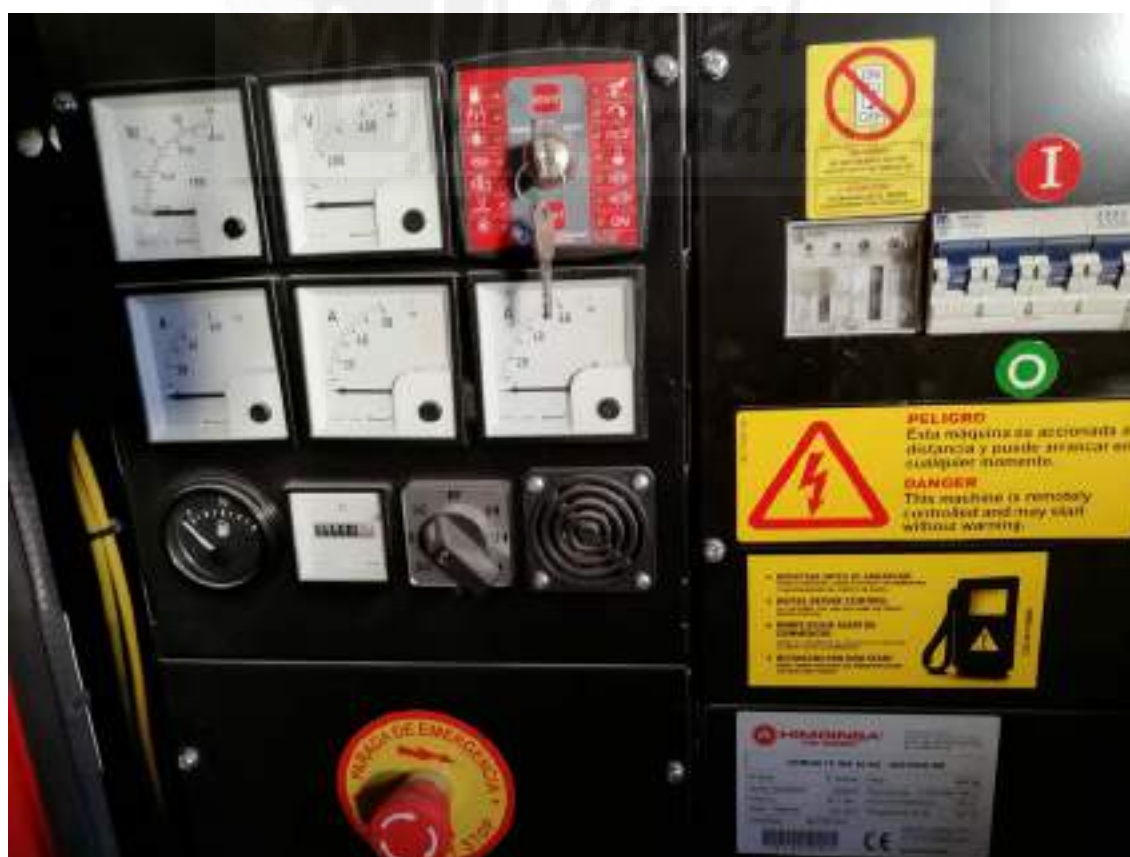
Foto 36: Cuadro eléctrico del grupo electrógeno
