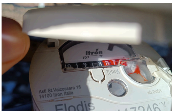
Figura 5 Manipulación mediante perforación en contador de agua potable
