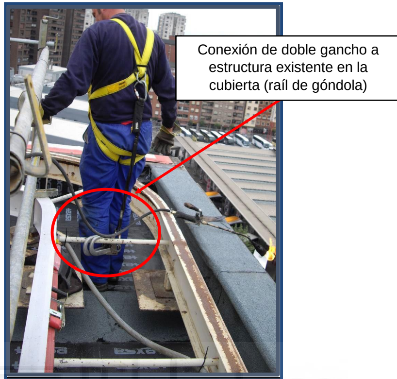
Figura 31 Conexión de doble gancho a estructura
