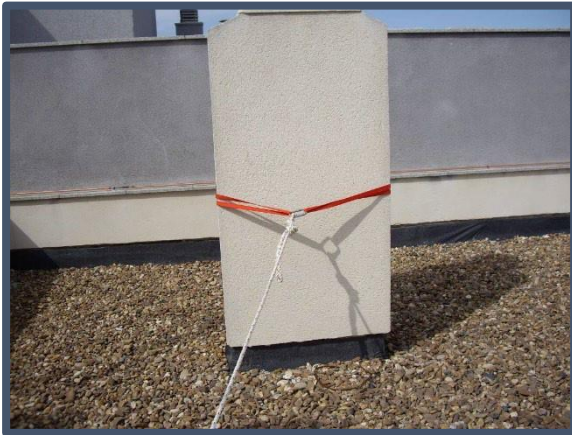
Figuras 13 y 14 Puntos de anclaje estructurales mediante cindill
