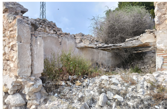
Imagen 12. Fotografía actual de una vivienda derrumbada en Almarra. Fuente: Elaboración propia.
