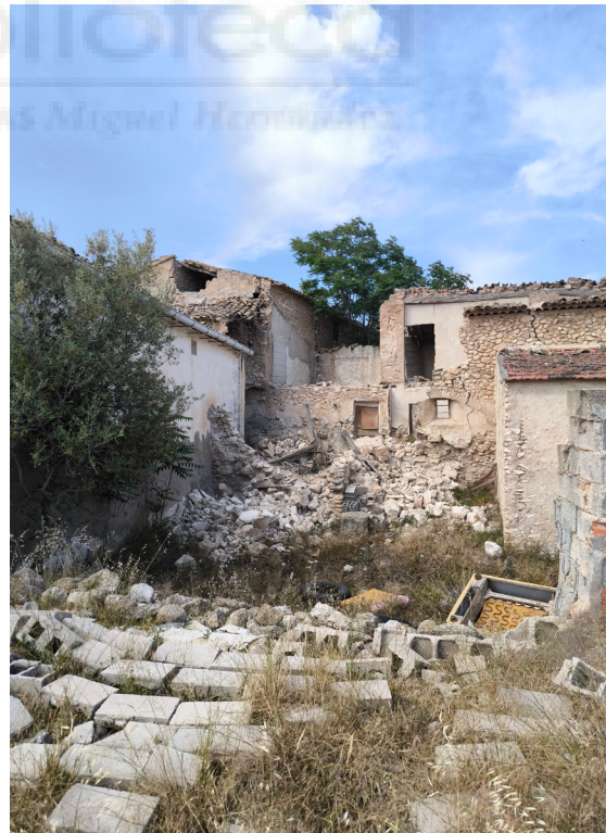
Imagen 15. Fotografía actual del espacio interno de varias viviendas derrumbadas en Almarra. Fuente: Elaboración propia.
