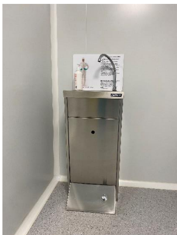
Imagen 11: lavabo de manos en exclusiva de preparación de peligrosos
