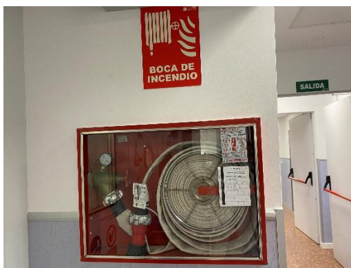
Imagen 12: Boca de incendio en entrada de acceso a Sala Blanca
