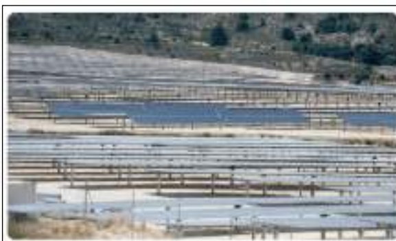
Figura 3.2. Instalación fotovoltaica en Alicante
