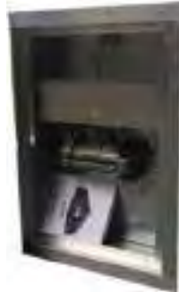
Equipos cableados a cuadro eléctrico integrado en el equipo.
