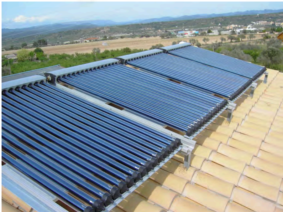
Figura 11. Captador solar de tubos de vacío instalado sobre un tejado a dos aguas.
