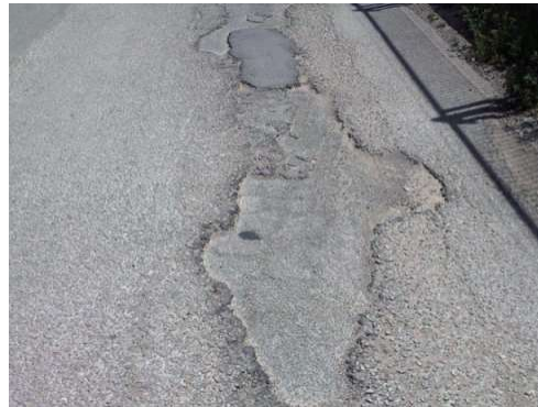
Peladuras del firme
