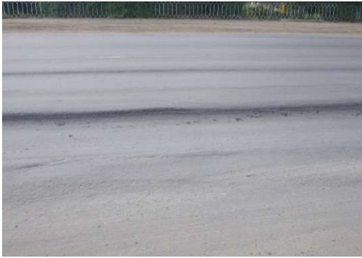
Deformaciones del firme, roderas
