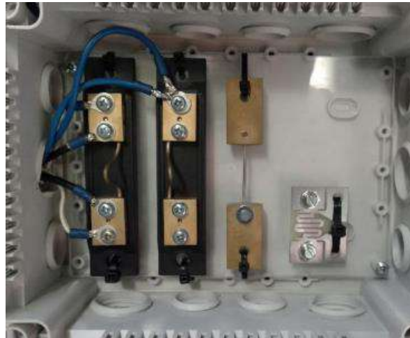
Figura 3.28: Resistencias shunt en el interior de la instalación del equipo de climatización.
