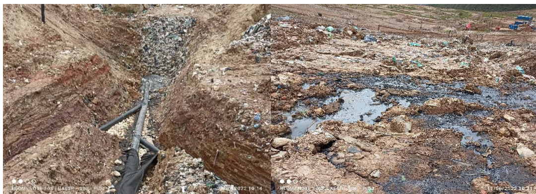
Figura 17. Construcción de dren de captación de lixiviado - Afloramiento de Lixiviado. Fuente: Elaboración propia.
