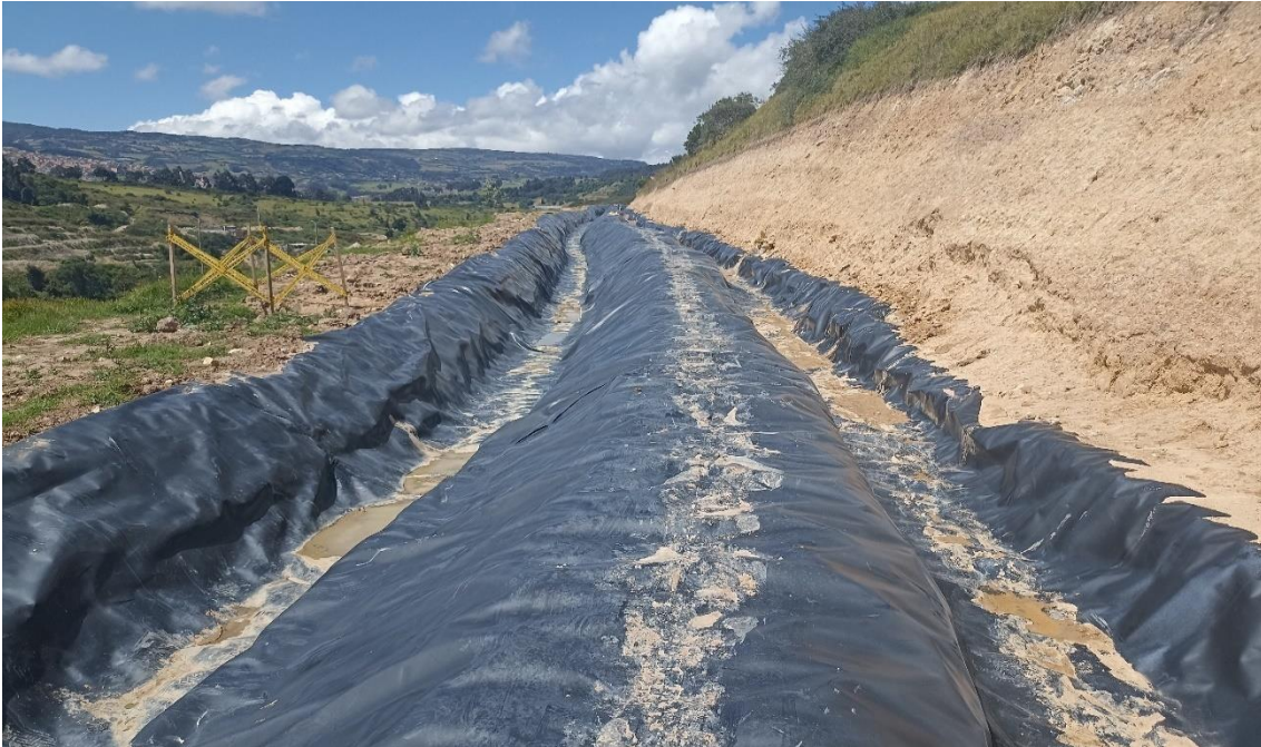
Figura 18. Construcción de canal paralelo a canal de conducción de lixiviado para recolección de agua de precipitación sobre talud lateral.
