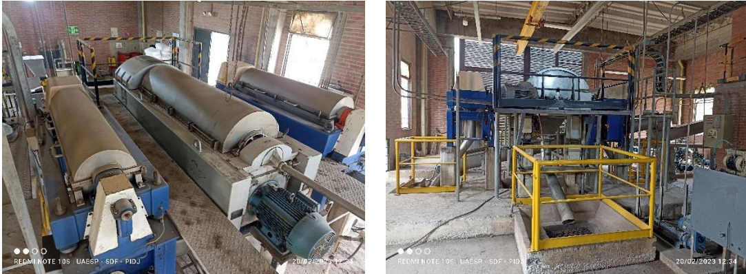
Figura 25. Centrífugas de deshidratación de lodos generados en los tratamiento fisicoquímico del Lixiviado
