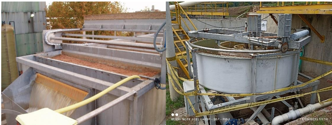
Figura 21. Sistema de Flotación por Aire Disuelto. Fuente: (ESTRUAGUA, 2019) y elaboración propia.
