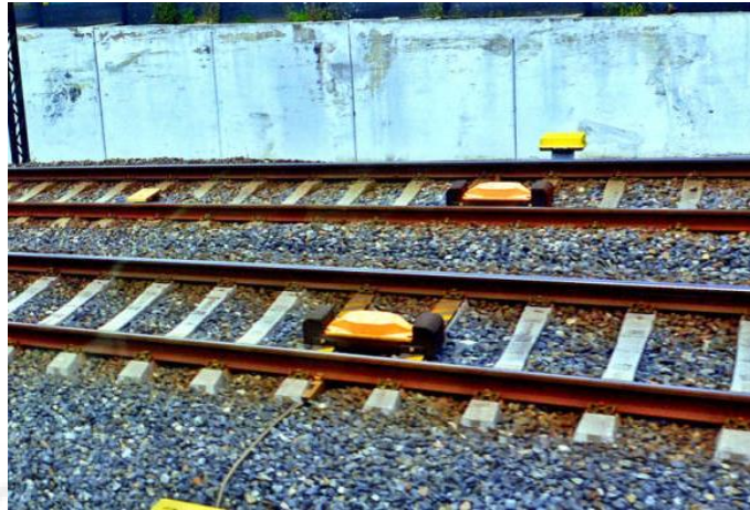
Ilustración 3- Baliza ASFA instalada en vía
