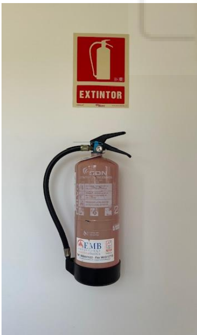
Ilustración 46. Segundo Extintor ABC, ubicado en cada pasillo. EP
