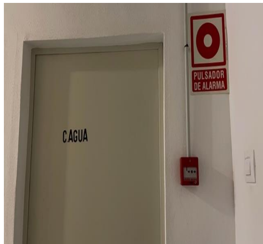
Ilustración 34. Pulsador de alarma al lado del contador de agua. EP
