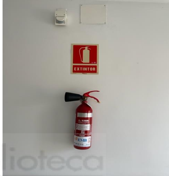
Ilustración 42. Extintor en el Portal. EP
