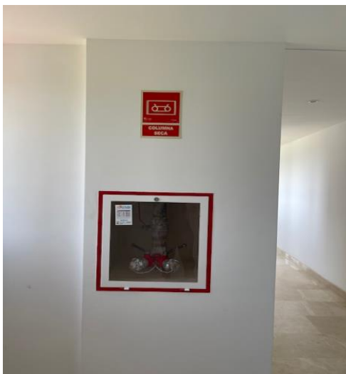
Ilustración 51. Columna Seca en pasillo. EP
