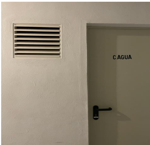
Ilustración 33. Ventilación del cuarto contador de agua. EP
