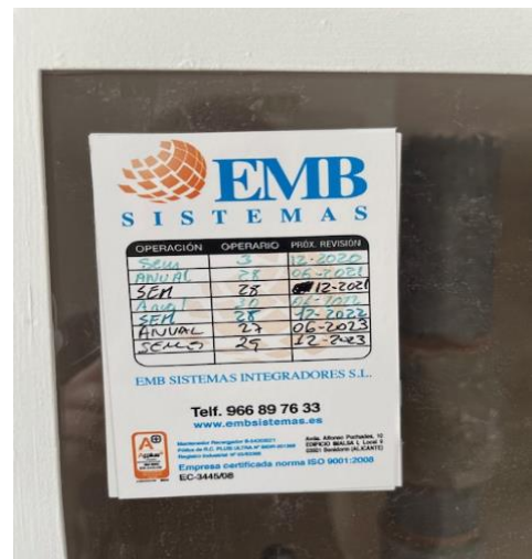
Ilustración 52. Etiqueta de inspección (Diciembre-2023) EP
