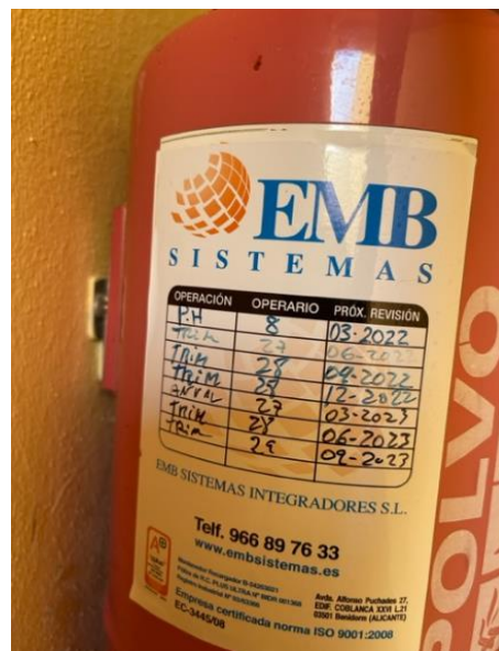
Ilustración 23. Etiqueta de inspección del extintor. EP
