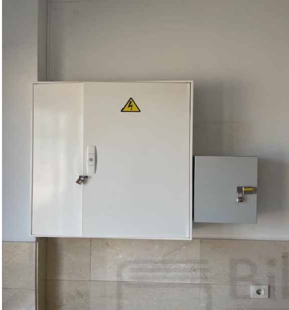
Ilustración 41. Cuadros Eléctricos en el Portal. EP
