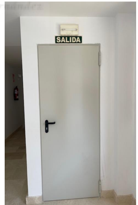
Ilustración 48. Puerta de salida de emergencia. EP
