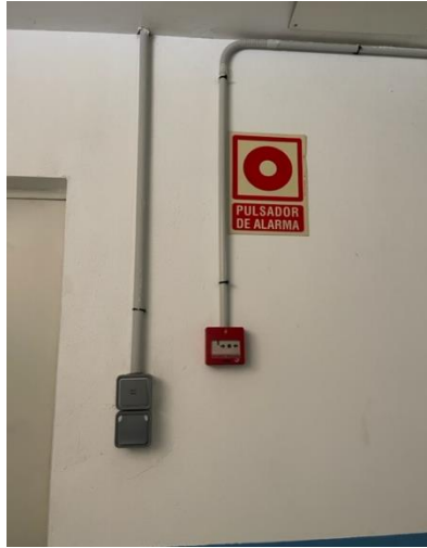
Ilustración 25. Pulsador de alarma. EP
