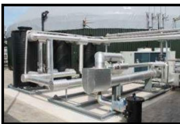
Ilustración 50. Sistema de enfriamiento y secado del biogás.
