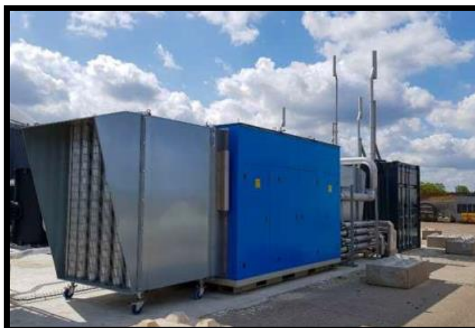
Ilustración 53. Compresor de biogás alojado en compartimento para su instalación en exteriores.
