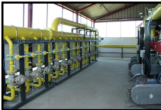
Ilustración 9. Estación de regulación y medición (ERM) en una red de pozos de vertedero.
