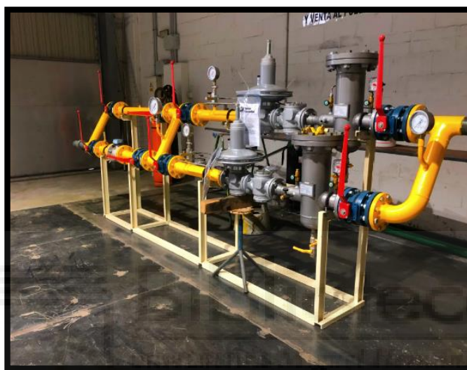
Ilustración 60. Ejemplo de sistema de regulación y medición (ERM) montado en un SKID (ENEGAS).
