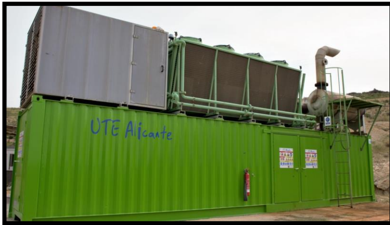
Ilustración 48. Motores de generación eléctrica usando biogás.
