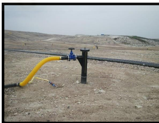
Ilustración 8. Red de pozos para la desgasificación de un vertedero.
