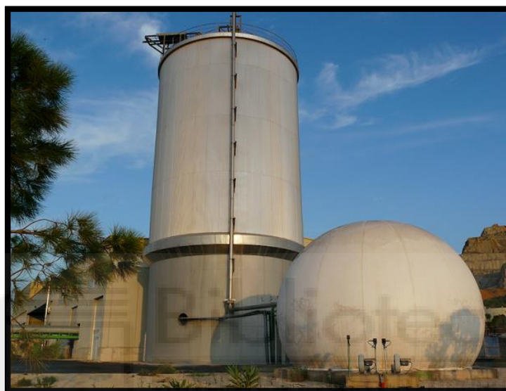
Ilustración 36. Vista del digestor instalado en el C.E.T.R.A.
