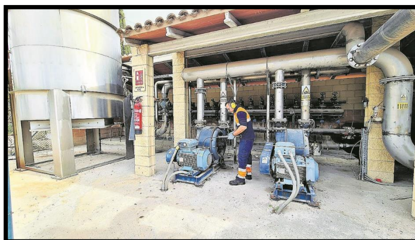
Ilustración 46. Fotografía del sistema de tratamiento de biogás instalado.
