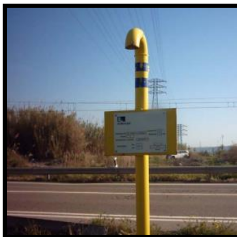
Ilustración 70. Ejemplo de respiradero en un cruce de carretera.
