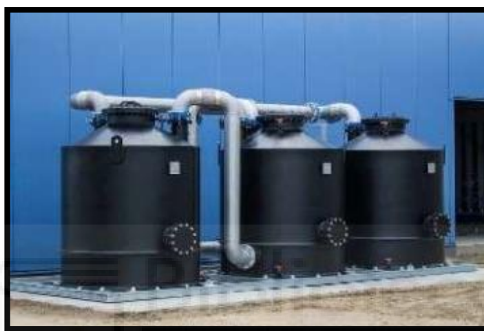
Ilustración 52. Sistema de filtrado de biogás.
