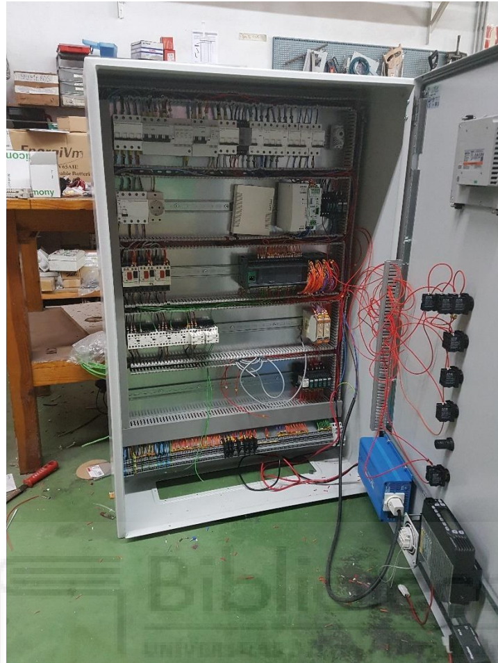
Imagen 28: FOTO DEL INTERIOR DEL ARMARIO ELECTRICO.
