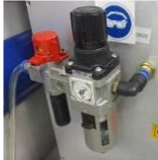
Imagen 49. Dispositivo válvula reguladora
