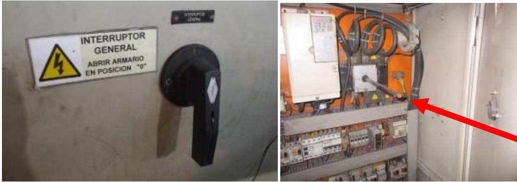
Imagen 50. Enclavamiento del cuadro
