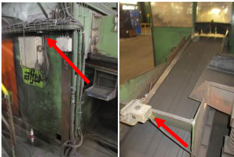
Imagen 56. Bandeja de cables
