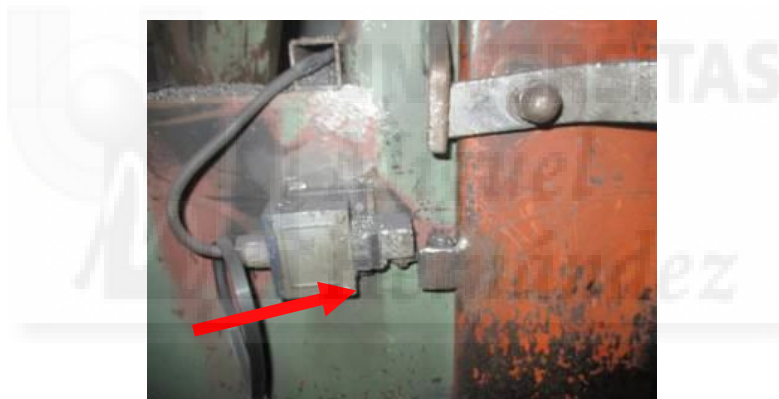
Imagen 30. Final de carrera elevador cangilones
