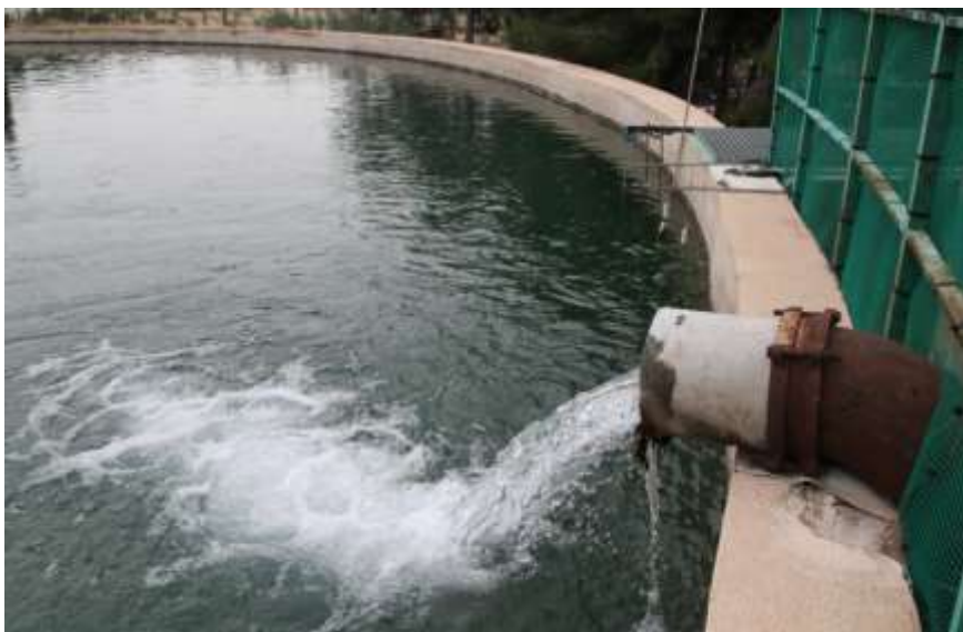
Figura 5: Detalle de la balsa de almacenamiento. Se observa el aporte de agua desde el pozo. Fuente: propia.
