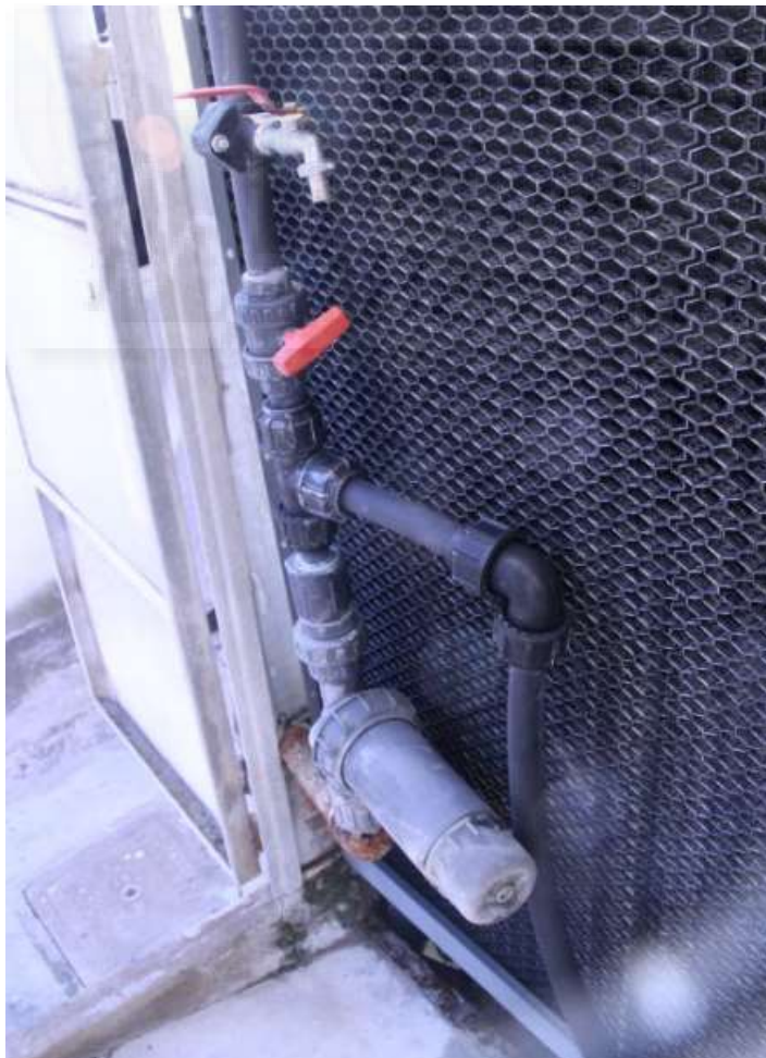
Figura 13: Detalle del sistema de refrigeración. Se observa la tubería de suministro del sistema, con un filtro de partículas. Fuente propia.
