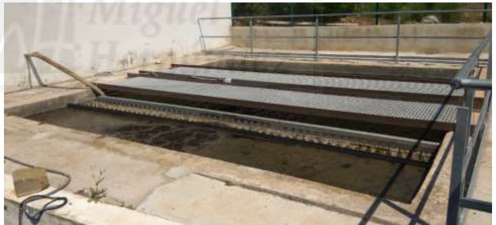
Figura 15: Balsas de decantación. Se eliminan los fangos. Fuente propia.
