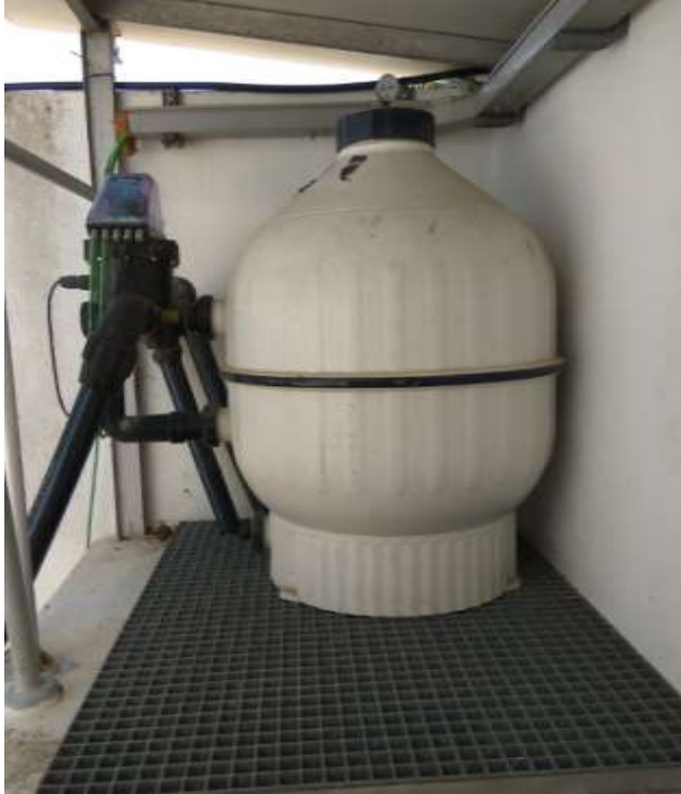
Figura 17: Filtro de arena. Se eliminan las partículas sólidas suspendidas. Fuente propia.
