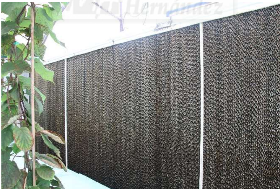
Figura 11: Sistema de refrigeración o cooling en los invernaderos del IVIA. Fuente: propia.
