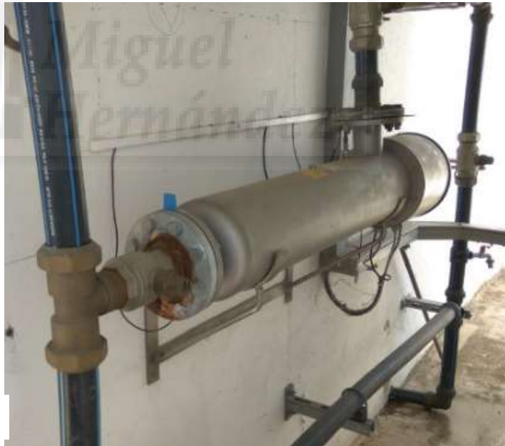
Figura 18: Filtro de rayos UV. Se elimina la carga biológica. Fuente propia.
