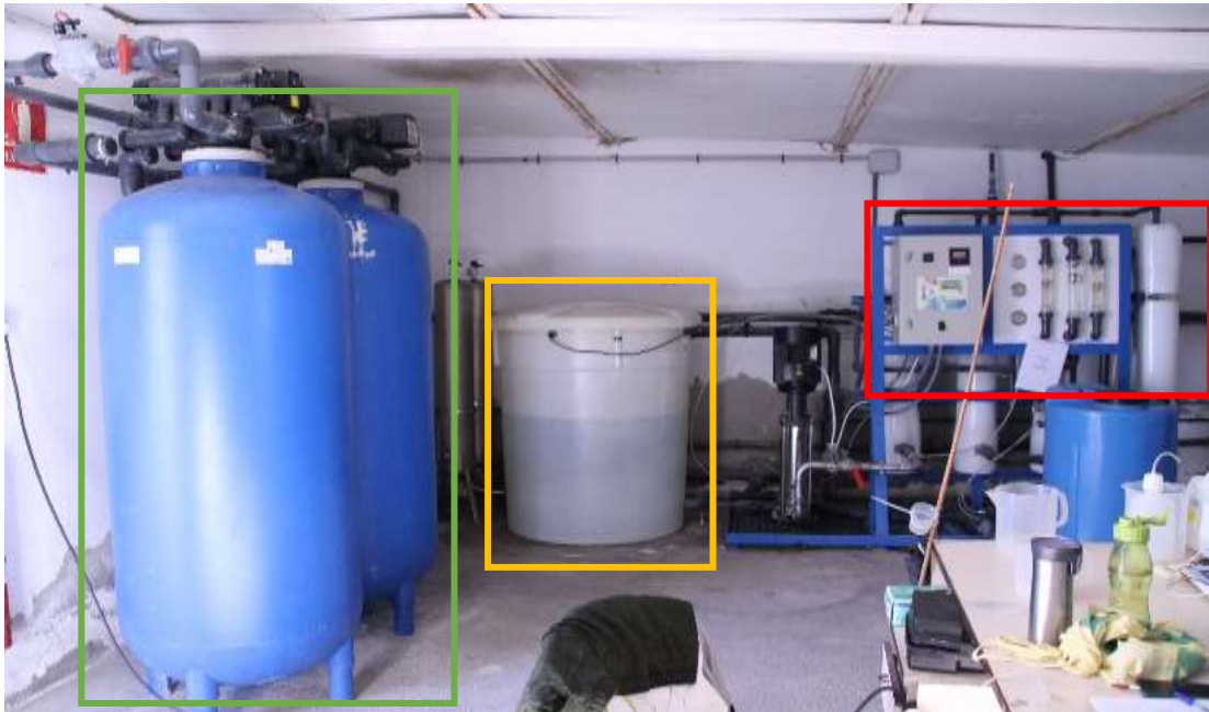
Figura 9: Parte de la ETAP. Se destacan en verde los filtros de carbono, en amarillo el acumulador, y el rojo una de las plantas de osmosis. Fuente: propia
