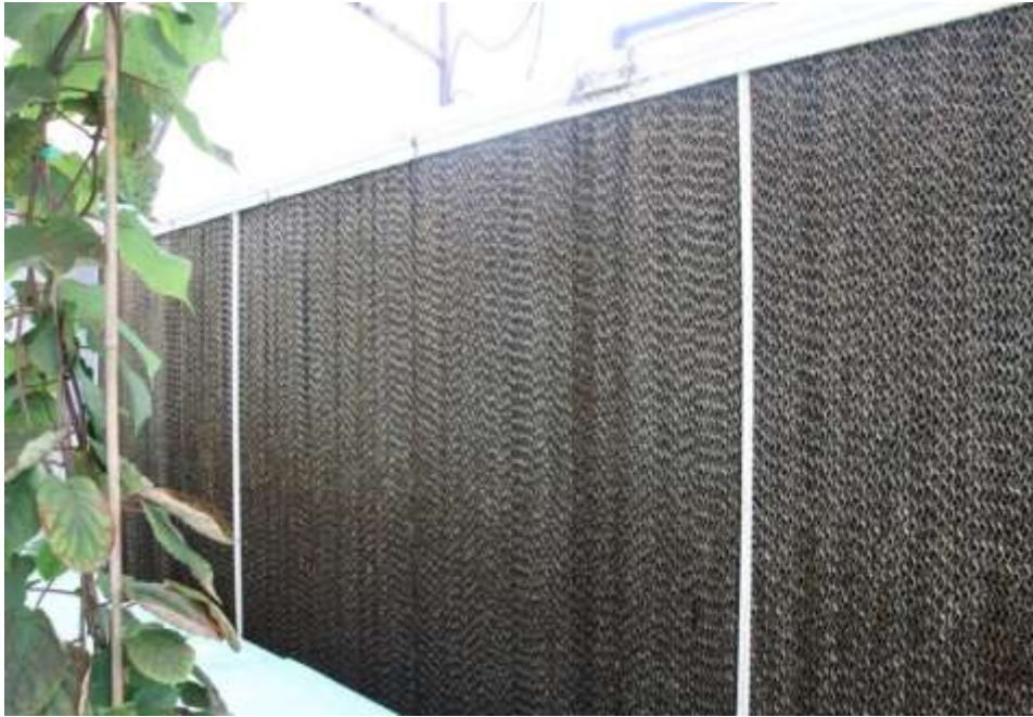
Figura 14: Paneles de celulosa del sistema de refrigeración de los invernaderos. Fuente propia.
