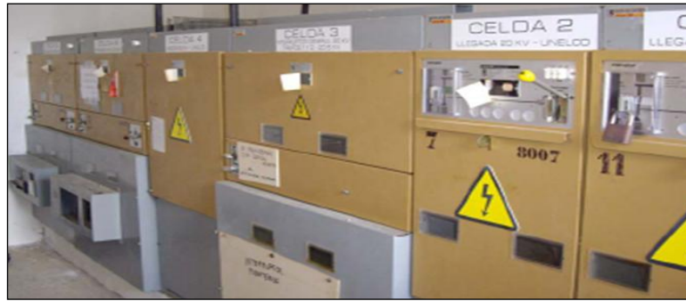
Fig. 10: CT con envoltente metálica
