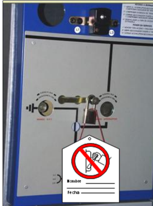
Fig. 25: Celda bloqueada con candado y señalizada
