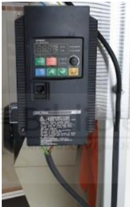
Figura 42: Variador de frecuencia del ventilador.
