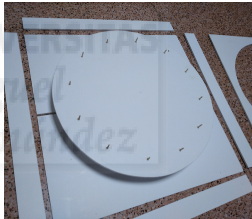
Fig. 54 Una vez colocado, se averigua la altura, se le añaden franjas laterales y cuatro ruedas que den estabilidad a la superficie.
