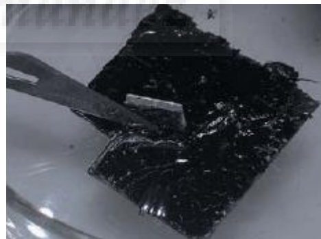
Figura 3. 7. Material no friable. Tela asfáltica.[7]
