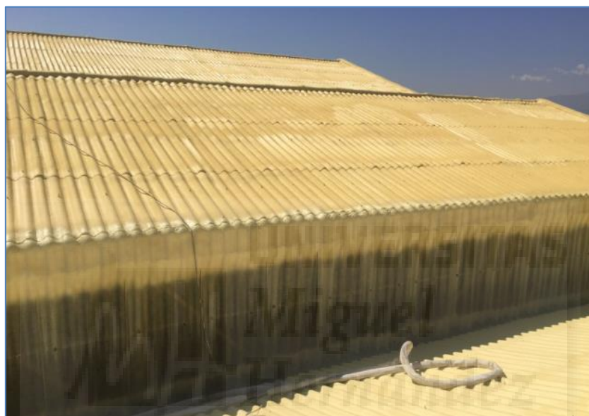
Figura 4. 2. Estabilización de MCA. Estado inicial.[28]
