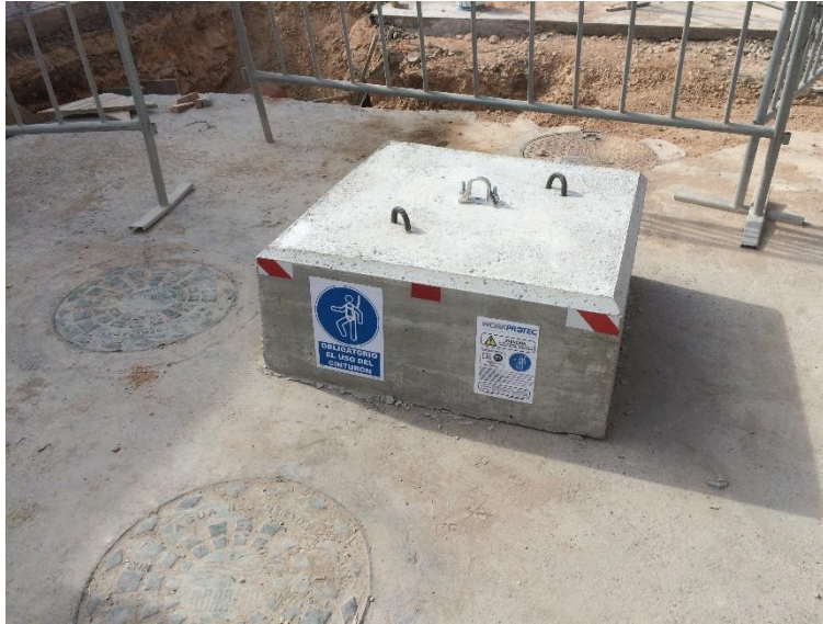
Ilustración 18 Punto de anclaje o peso muerto formado por lastre de hormigón armado. Fuente: elaboración propia.
